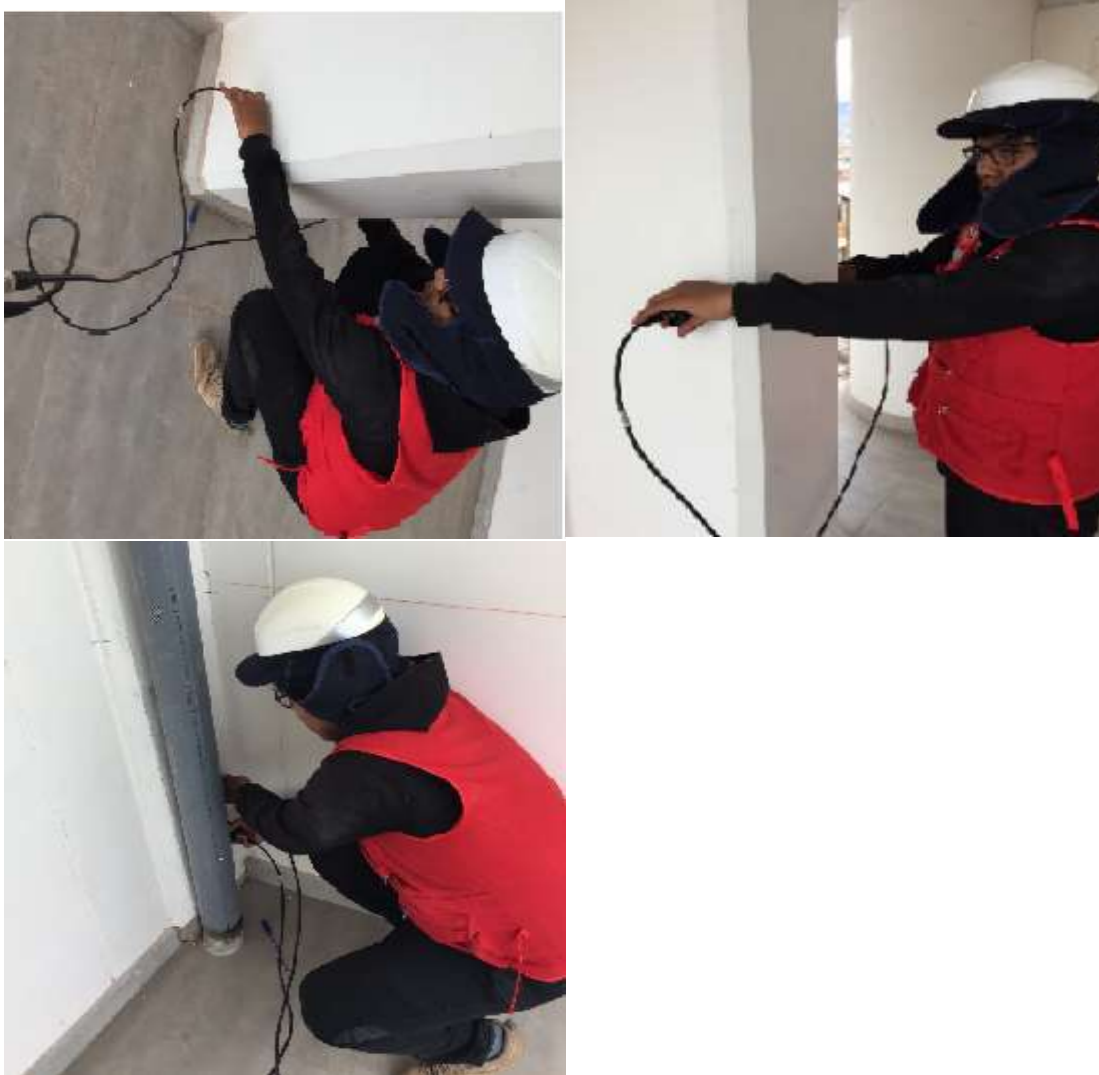
Figura 45 - Ensayo Ultra sonido- resistencia a la compresión Pundit PL interior-exterior en vigas del Cuarto nivel de la tribuna Occidente de los anillos del estadio Inca Garcilaso de la Vega.
