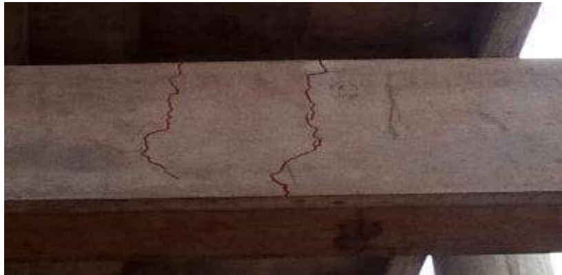
Figura 1 Patologías presentada en la viga transversal del eje 4 en la tribuna Oriente
