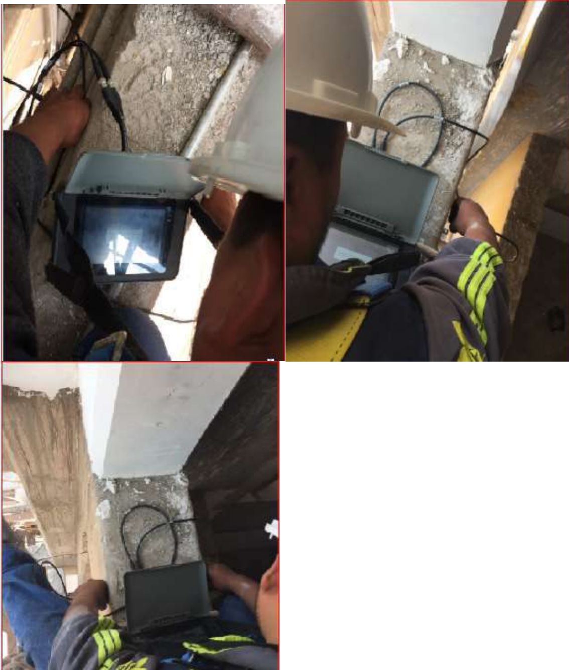
Figura 50 - Ensayo Ultra sonido- resistencia a la compresión Pundit PL interior-externo en vigas del Primer nivel de la tribuna Occidente de los anillos del estadio Inca Garcilaso de la Vega.
