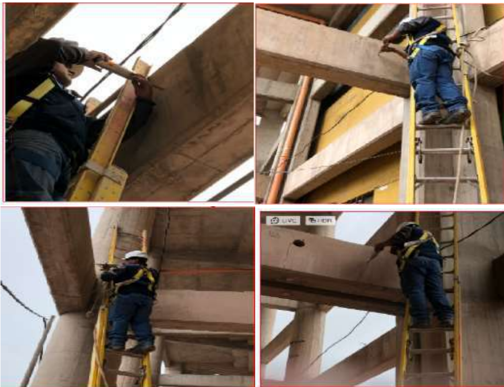
Figura 30 - Ensayo esclerómetro interior-exterior en columnas Quinto nivel de la tribuna occidente de los anillos del estadio Inca Garcilaso de la Vega
