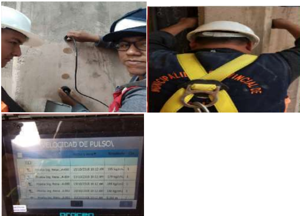
Figura 41 - Ensayo Ultra sonido- resistencia a la compresión Pundit PL interior-externo en vigas del Cuarto nivel de la tribuna Oriente de los anillos del estadio Inca Garcilaso de la Vega.
