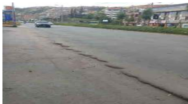
Figura 2. Carreteras asfaltadas en caliente defectuosa. Caso: Paradero Enaco (carril de bajada). Fuente: Elaboración propia.
