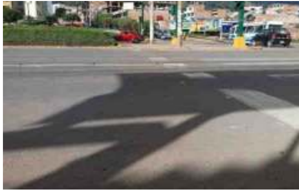
Figura 1. Carretas asfaltadas en caliente defectuosas. Caso: Prolongación Av. La cultura (altura UAC). Fuente: Elaboración propia.
