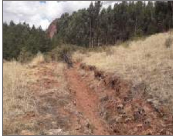
Figura 44 Sistema de drenaje en Hatun Huayco
