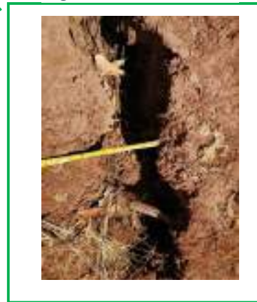
Figura 25 Grietas de 5cm
