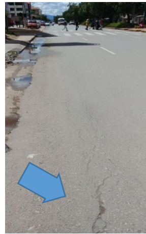
Figura 7: Fisuras longitudinales Av. De la Cultura en la (frente al Real Plaza)
