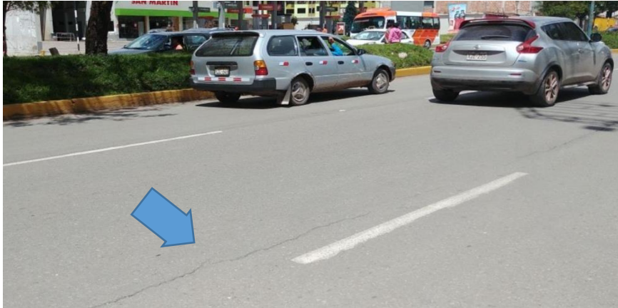
Figura 5: Fisuras longitudinales en la av. De la Cultura (frente al grifo San Martin)
