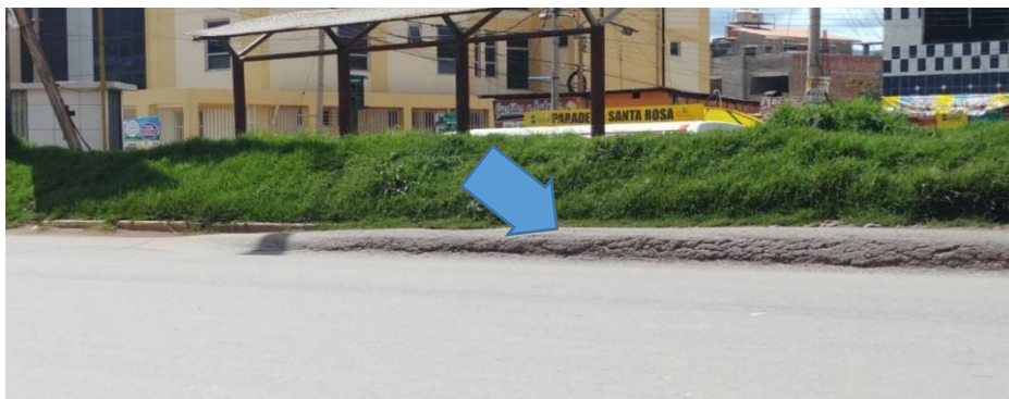
Figura 4: Deformación por deficiencia estructural / ahuellamiento en la Av. De la Cultura (paradero Santa Rosa)
