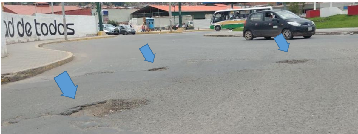
Figura 1: Baches en el Ovalo Libertadores
