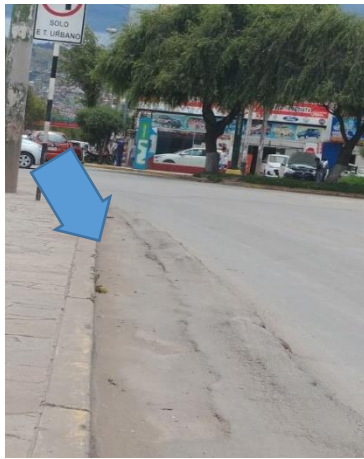
Figura 6: Fisuras longitudinales en la Vía Expresa (Parque Puccllaycancha)
