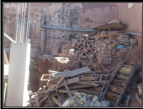
F8 Material acumulado dificultando procedimientos de construcción.
