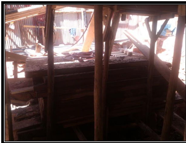
F3 Se puede apreciar la falta de espacios para guardar materiales.
