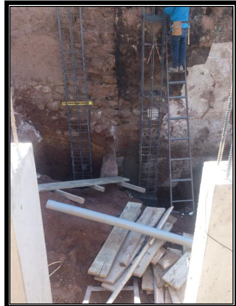
F7 Material acumulado dificultando procedimiento para izar columnas.
