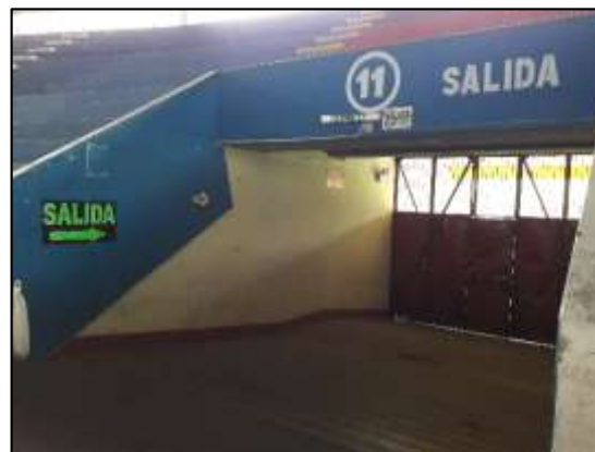
Figura 108. Recolección de datos en el Tramo 11 –interior Coliseo Casa de la Juventud - rampas
