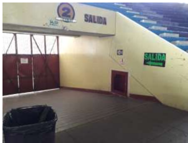
Figura 90. Recolección de datos en el Tramo 2 –interior Coliseo Casa de la Juventud - rampas
