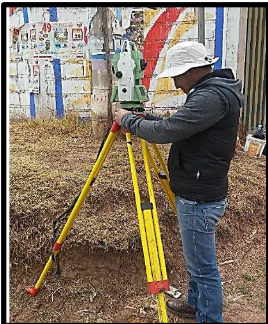
Figura 67. Replanteo con la Estación Total Leica TS06 PLUS, con la función para replantear. Fuente: Elaboración propia 2019.
