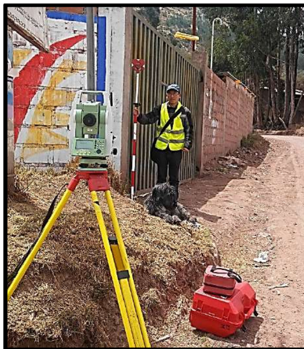
Figura 61. Disparó con láser de la Estación Total al prisma ubicado en esquinas, veredas, postes y predios de vivienda. Fuente: Elaboración propia 2019
