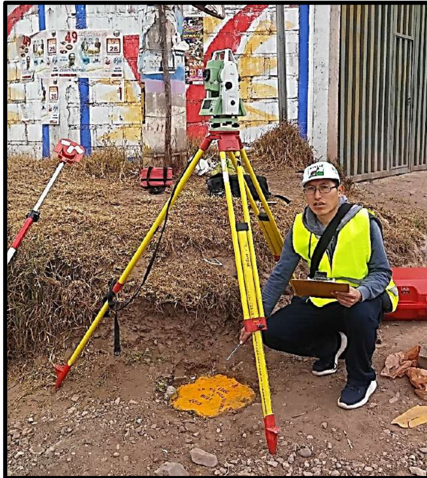
Figura 57. Estacionamiento de la Estación Total en P.C. 1 para orientación por coordenadas del levantamiento topográfico del tramo de la carretera en estudio. Fuente: Elaboración propia
