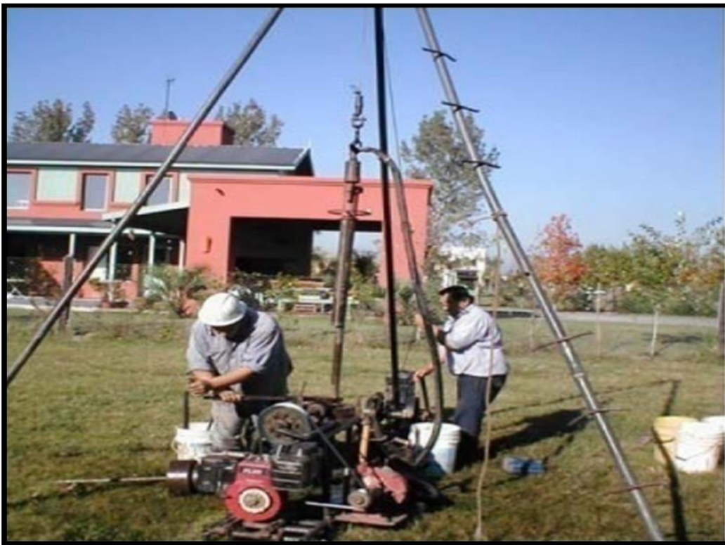
Figura 17. Vista del Dispositivo de Perforación Fuente: Universidad Tecnológica Nacional – Buenos Aires.
