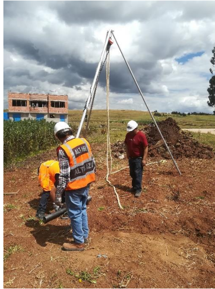
Figura 82. Instalacion del muestreador de 2"
