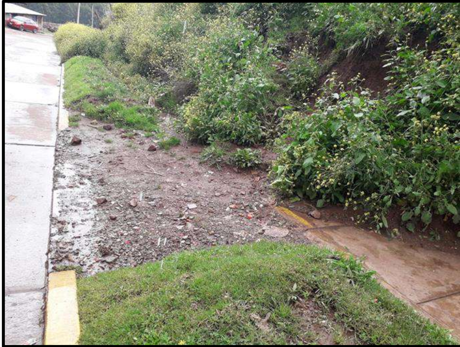
Figura N° 21 Discontinuidad de veredas y deslizamiento de talud
