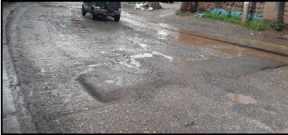
Figura N° 19 Disipador de velocidad en mal estado 01+700 Km
