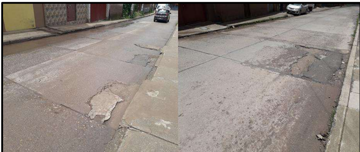
Figura N° 18 Demarcaciones ausente y pavimento en mal estado km 01+560
