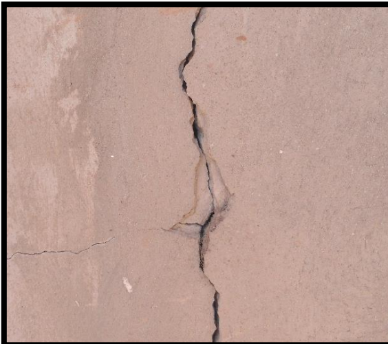
Fotografía 3. Fisuras en acabados
