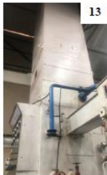
Torre de enfriamiento
