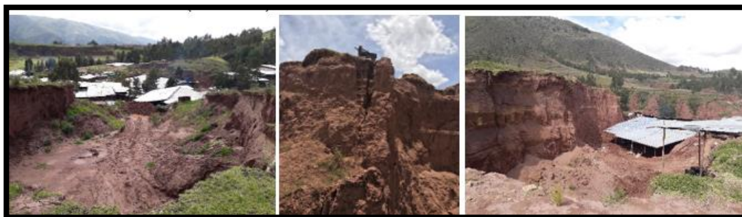
FIGURA 1 Desestabilización de suelo en la Zona Ladrillera del distrito de San Jerónimo – Cusco. (Elaboración Propia).
