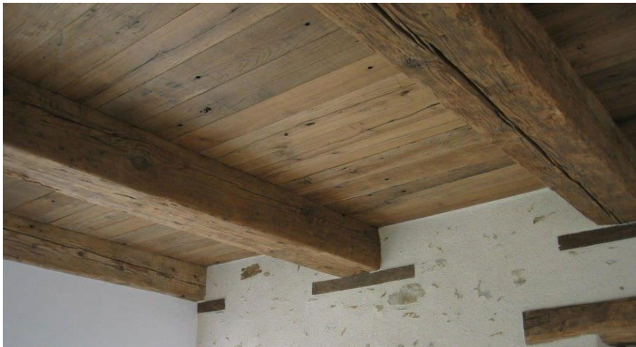
Figura 2. Deformación y agrietamiento de vigas de madera. Fuente: Elaboración propia
