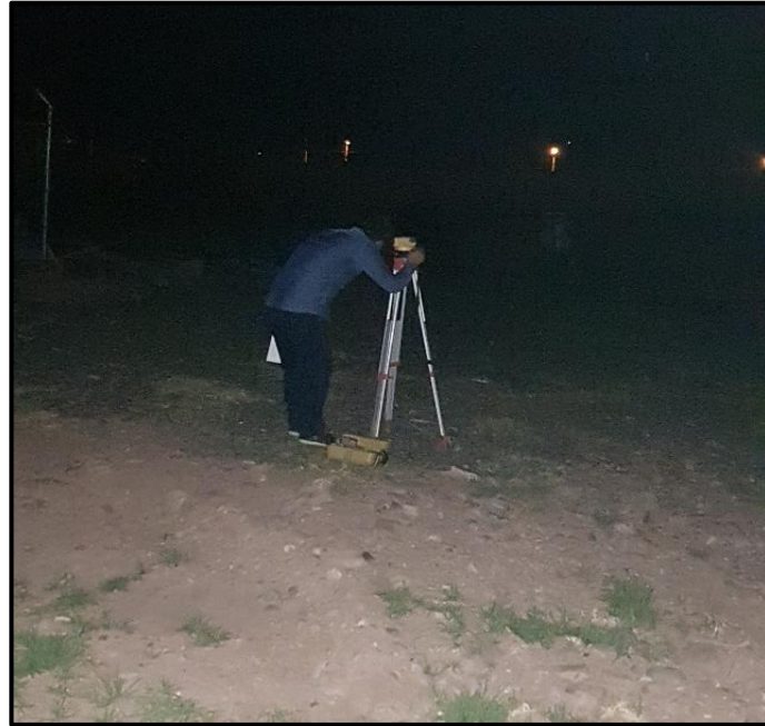
Figura 32: Niveles de estructuras en la planta de tratamiento de Saylla
