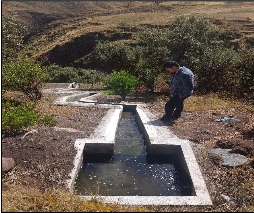
Figura 3: Planta de tratamiento de aguas residuales del C.P. de Huacoto.
