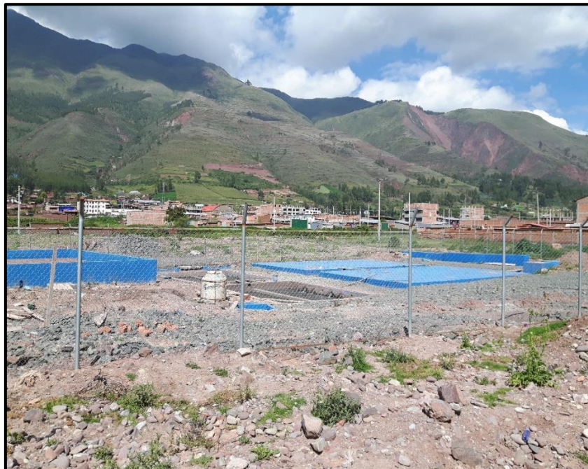
Figura 4: Planta de tratamiento de aguas residuales del distrito de Saylla.
