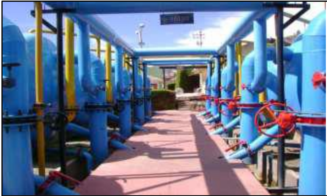
Figura N° 1: Vista Frontal de los filtros dispuestos paralelamente en la PTAP Santa Ana - Cusco.
