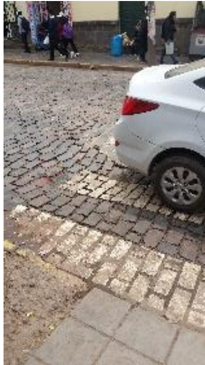
Fotografía 13: Mal estado de las Calzadas
