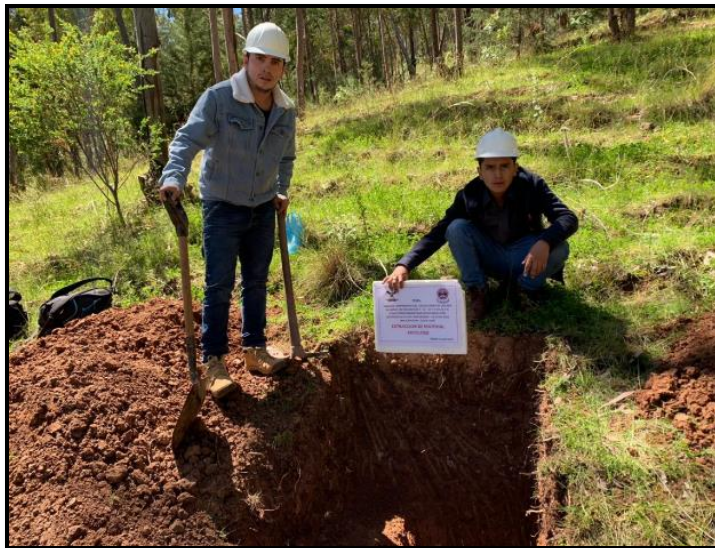
Figura 21 Material Extraído de la calicata APV. Kari Grande - Vía Rumiwasi Fuente: Elaboración Propia
