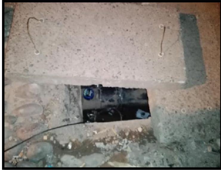
Figura N° 44: Instalación de Caudalímetro Ultrasónico PT878 en CL. Tecsecocha
