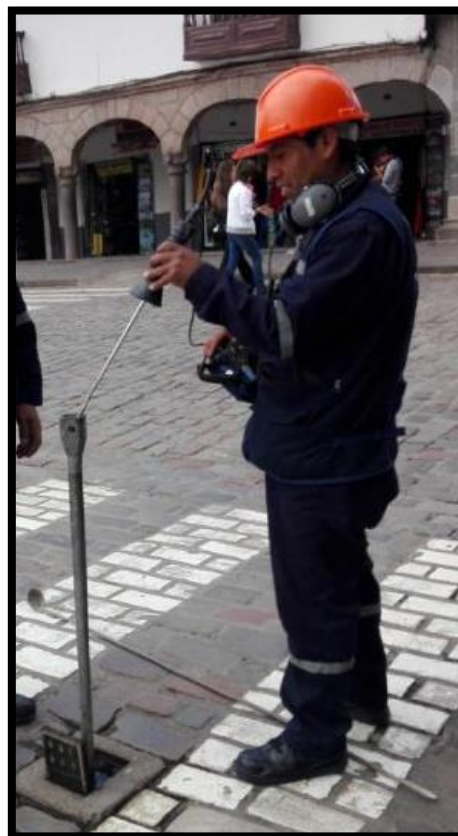
Figura N° 39: Verificación de hermeticidad de la válvula con apoyo del personal técnico
