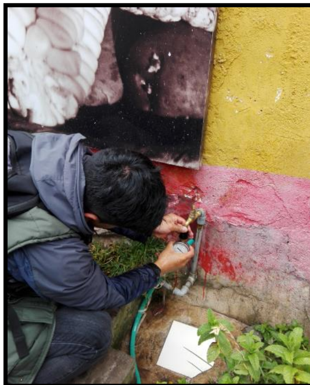
Figura N° 37. Medición de la presión en la CL. Carmen Alto
