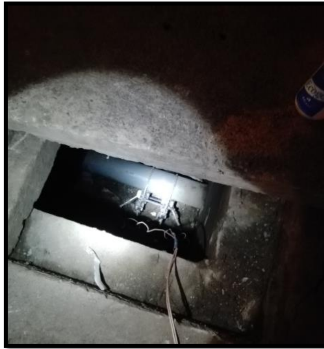
Figura N° 42: Instalación de Caudalímetro Ultrasónico PT878 en CL. Asnoqchutun
