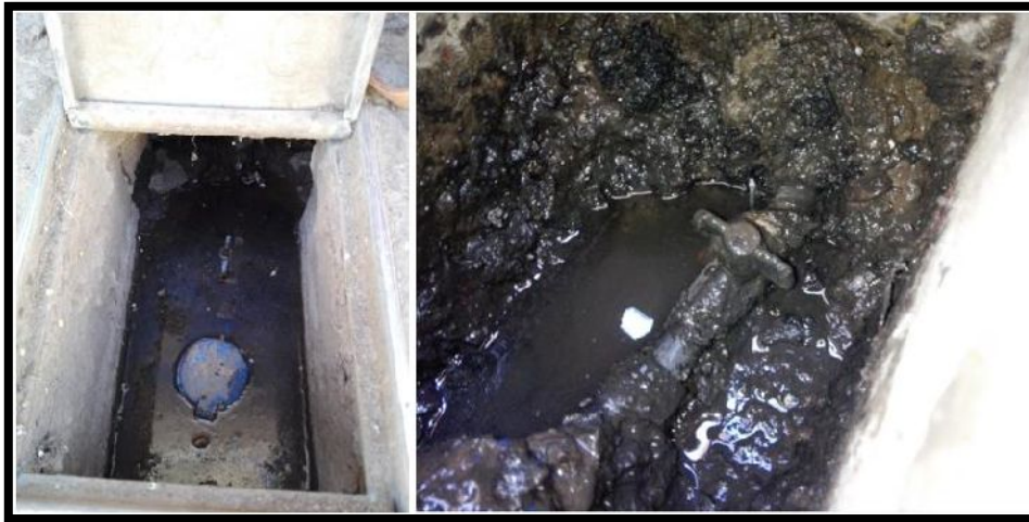
Figura N° 50: Exposición de la fuga localizada
