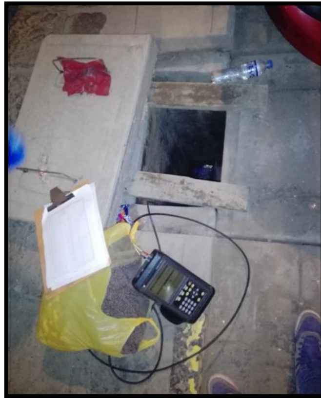
Figura N° 46: Instalación de Caudalímetro Ultrasónico PT878 en CL. Choquechaka
