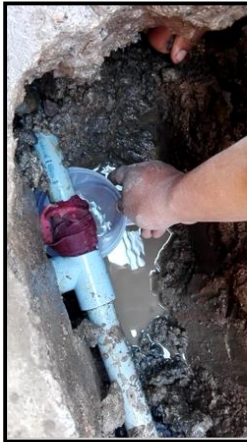
Figura N° 62: Exposición de fuga en acometida
