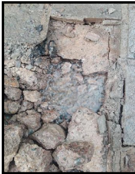
Figura N° 48: Fuga visible en la superficie
