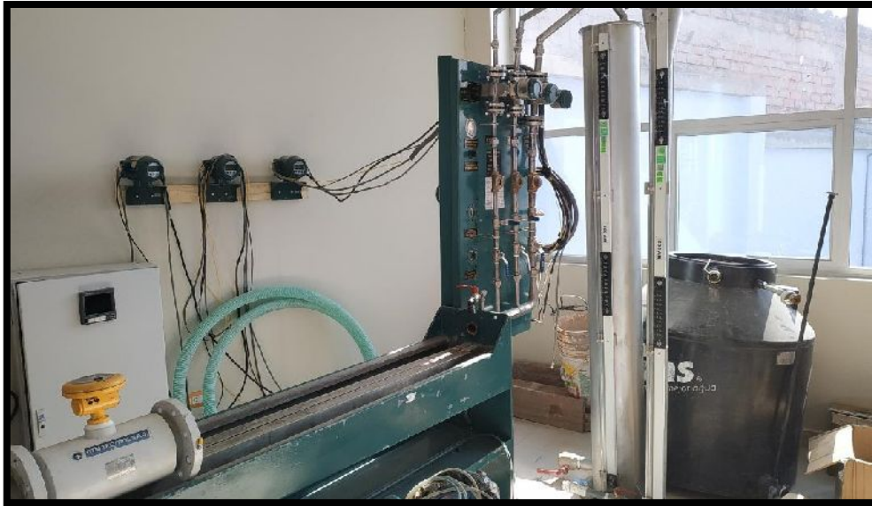
Figura N° 3: Banco de medidores inoperativo de la EPS Sedacusco
