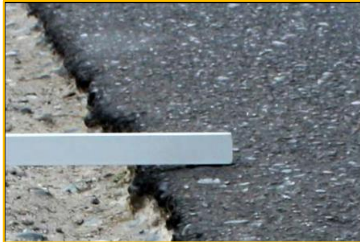
FIGURA N° 52: DESNIVEL CARRIL - BERMA
