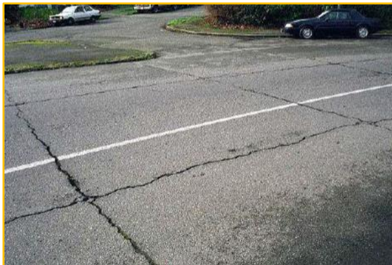
FIGURA N° 39: FISURAS DE REFLEXIÓN DE JUNTA
