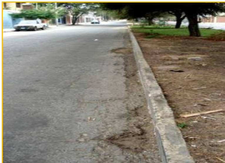
FIGURA N° 38: FISURAS DE BORDE
