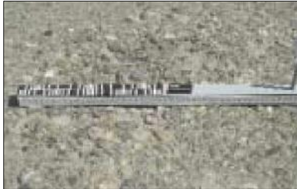
Figura 60: Falla tipo 18: Disgregación y Desintegración de nivel de severidad alta (H).
