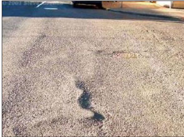
Figura 49: Falla tipo 15: Deformación por empuje.
