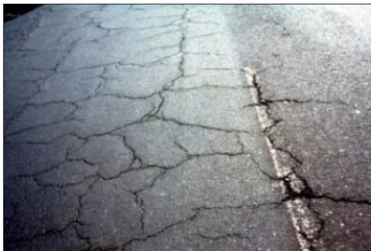
Figura 18: Falla tipo 3: Grietas de contracción (bloque). Nivel de severidad medio (M).
