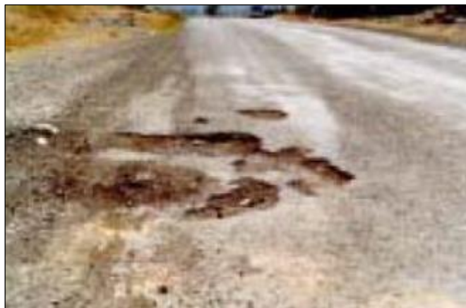
Figura 45: Falla tipo 13: Baches de nivel de severidad alto (H).
