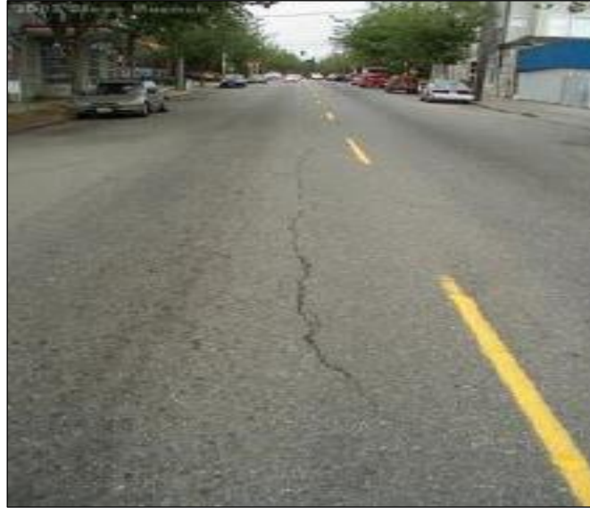
Figura 35: Falla tipo 10: Grietas longitudinales y transversales de nivel de severidad bajo (L).
