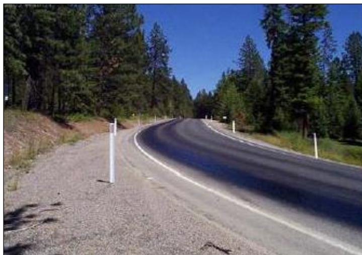
Figura 15: Falla tipo 2: Exudación Nivel alto (H).
