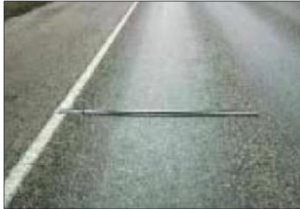
Figura 46: Falla tipo 14: Ahuellamiento de nivel de severidad bajo (L).
