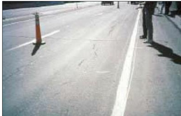
Figura 9: Falla tipo 1: Piel de cocodrilo nivel bajo (L).
