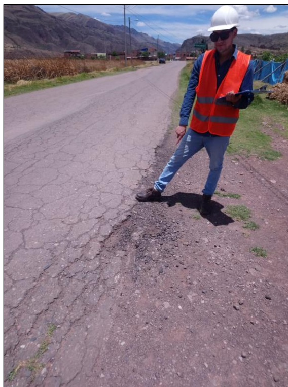
Figura 155 : Identificación de la falla 7 (grieta de borde).
