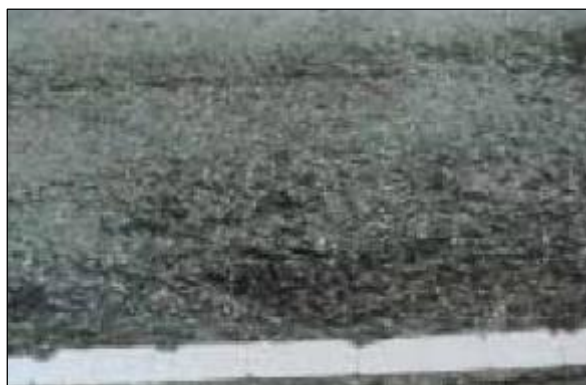
Figura 59: Falla tipo 18: Disgregación y Desintegración de nivel de severidad media (M).
