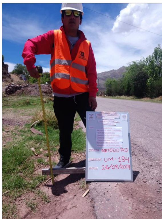
Figura 157: Identificación de la falla 9 (desnivel carril/berma).
