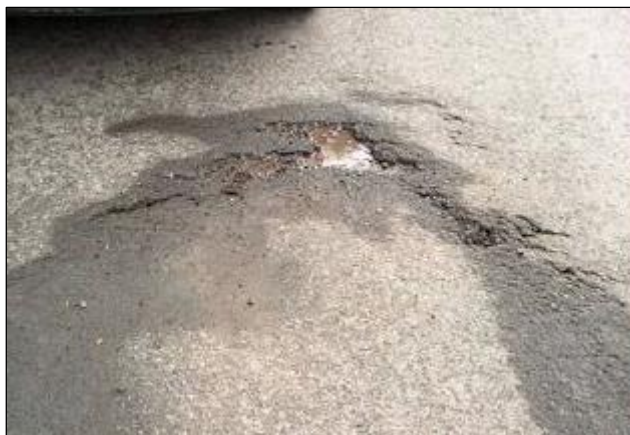
Figura 52: Falla tipo 16: Grietas por desplazamiento (fisuras parabólicas)
