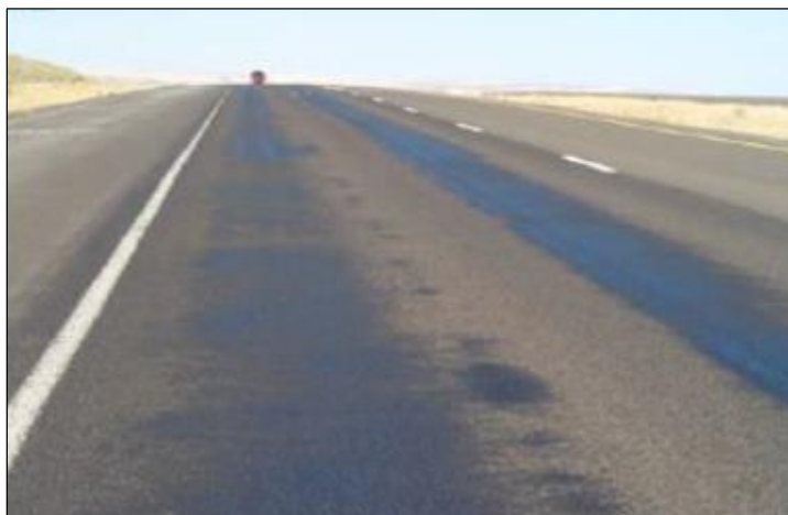
Figura 14: Falla tipo 2: Exudación Nivel medio (M).
