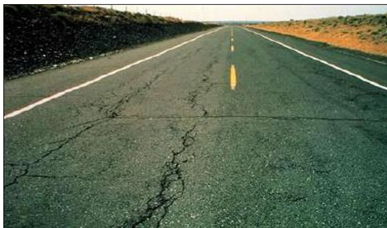
Figura 16: Falla tipo 3: Grietas de contracción (bloqueo).
