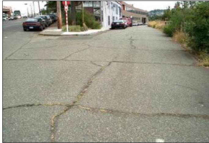
Figura 31: Falla tipo 8: Grietas de reflexión de juntas de nivel de severidad alta (H).
