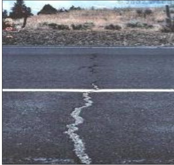
Figura 37: Falla tipo 10: Grietas longitudinales y transversales de nivel de severidad alto (H).
