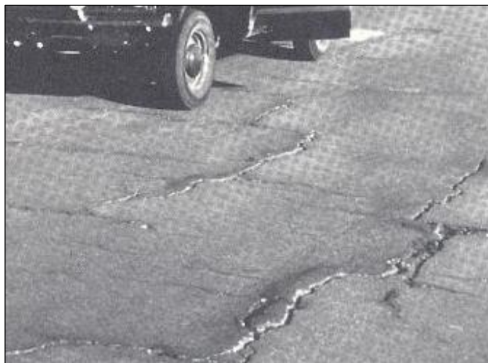
Figura 19: Falla tipo 3: Grietas de contracción (bloque). Nivel de severidad alto (H).
