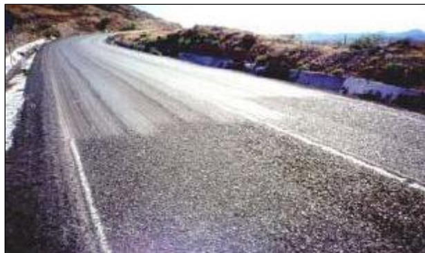
Figura 58: Falla tipo 18: Disgregación y Desintegración de nivel de severidad baja (L).
