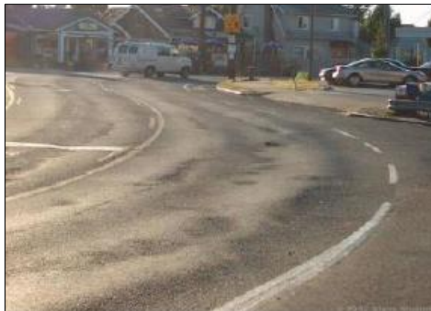
Figura 50: Falla tipo 15: Deformación por empuje de nivel de severidad medio (M).
