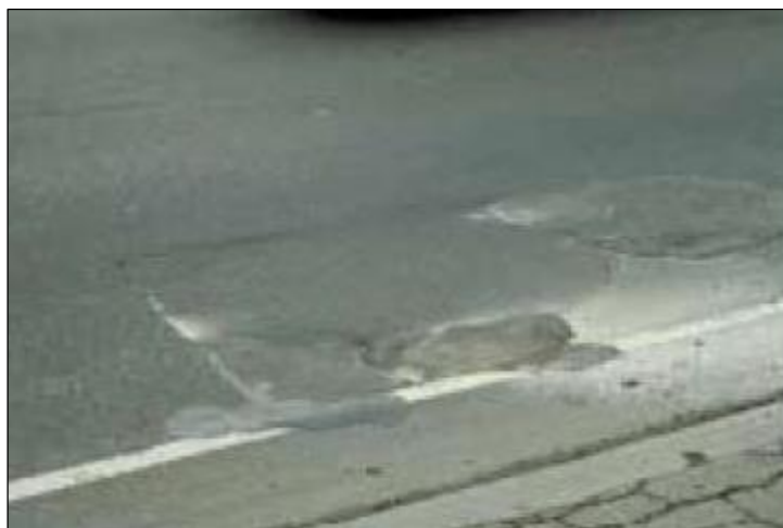
Figura 41: Falla tipo 11: Bacheo y zanjas reparadas de nivel de severidad alto (H).
