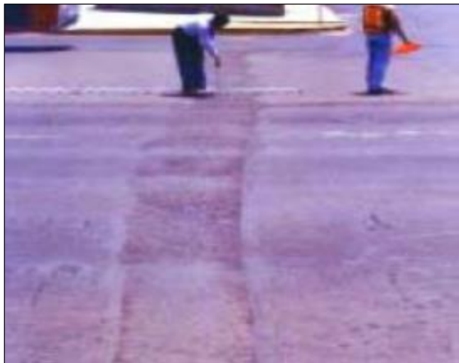
Figura 40: Falla tipo 11: Bacheo y zanjas reparadas de nivel de severidad media (M).
