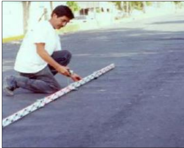
Figura 23: Falla tipo 5: Corrugaciones nivel de severidad media (M).
