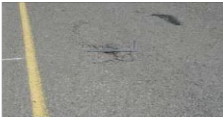
Figura 43: Falla tipo 13: Baches de nivel de severidad bajo (L).
