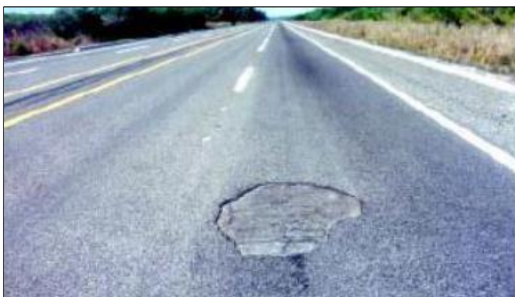
Figura 44: Falla tipo 13: Baches de nivel de severidad medio (M).
