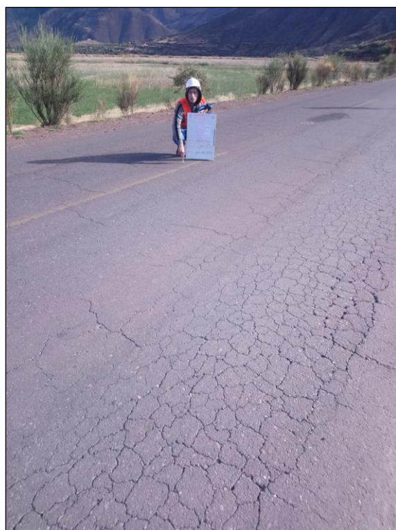
Figura 153 :Identificación de la falla 1 (piel de cocodrilo).
