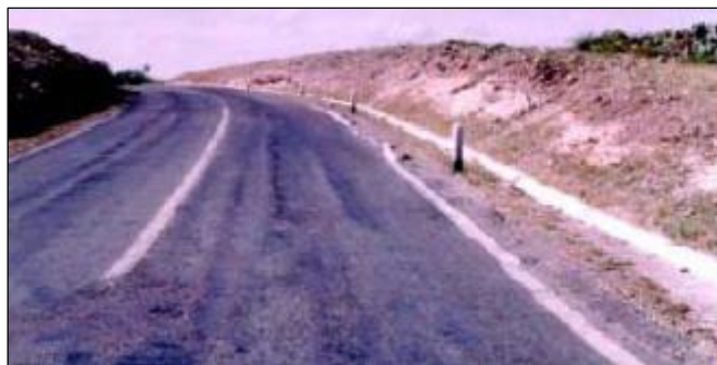
Figura 55: Falla tipo 17: Hinchamiento.
