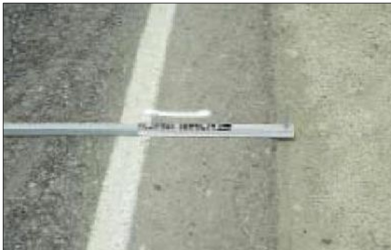
Figura 33: Falla tipo 9: Desnivel calzada-hombrilla nivel de severidad medio (M).
