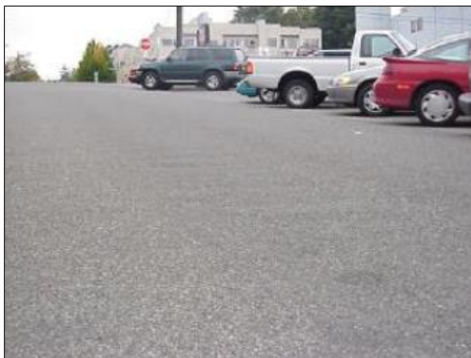
Figura 22: Falla tipo 5: Corrugaciones nivel de severidad baja (L).
