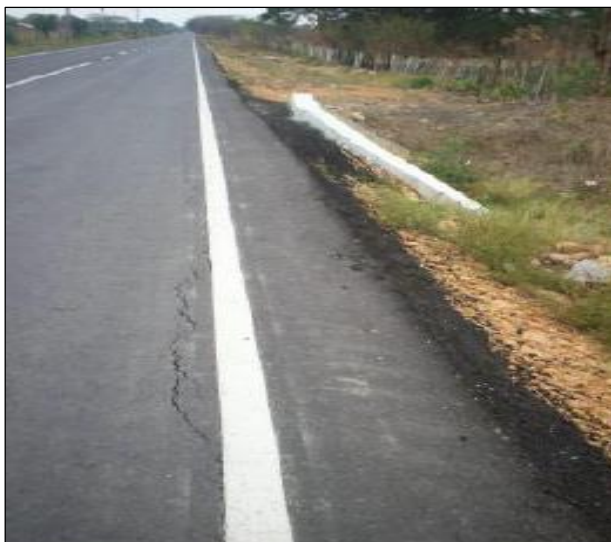
Figura 27: Falla tipo 7: Grietas o fisuras de borde de nivel de severidad baja (L).
