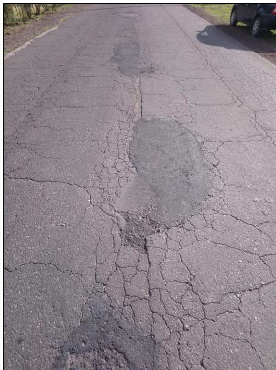
Figura 154: Identificación de la falla 11 (parqueo).
