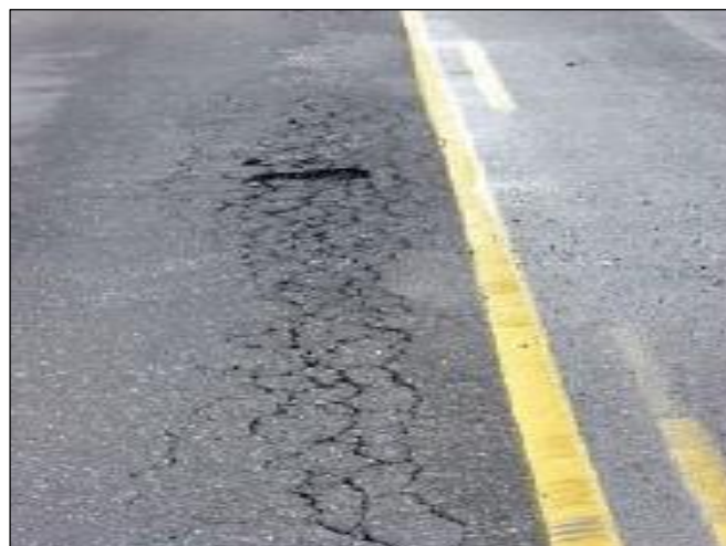
Figura 11: Falla tipo 1: Piel de cocodrilo nivel alto (H).
