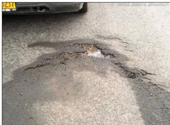
Figura 54: Falla tipo 16: Grietas por desplazamiento (fisuras parabólicas) de nivel de severidad alto (H).
