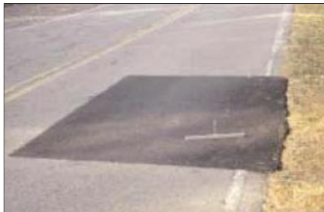
Figura 38: Falla tipo 11: Bacheo y zanjas reparadas.
