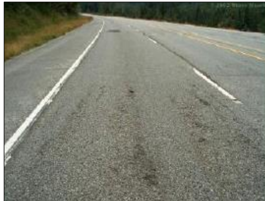
Figura 57: Falla tipo 18: Disgregación y Desintegración
