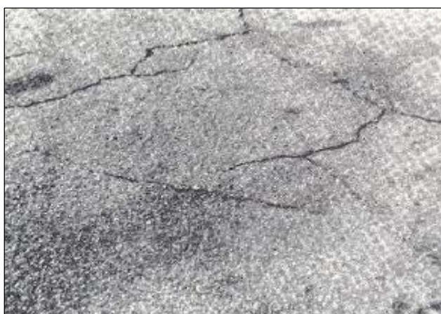
Figura 17: Falla tipo 3: Grietas de contracción (bloqueo). Nivel de severidad bajo (L).
