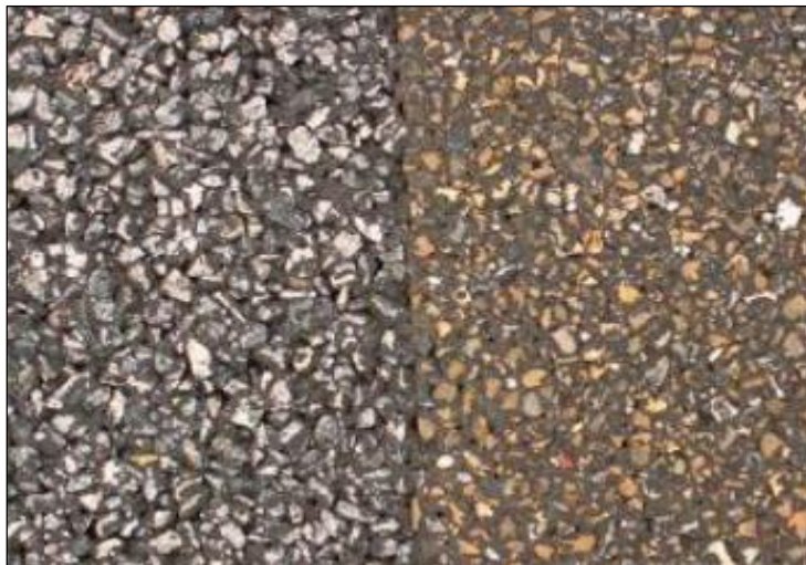
Figura 42: Falla tipo 12: Agregados pulidos.
