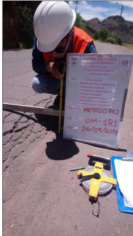
Figura 160 :Identificación de la falla 4 (abultamientos y hundimientos).
