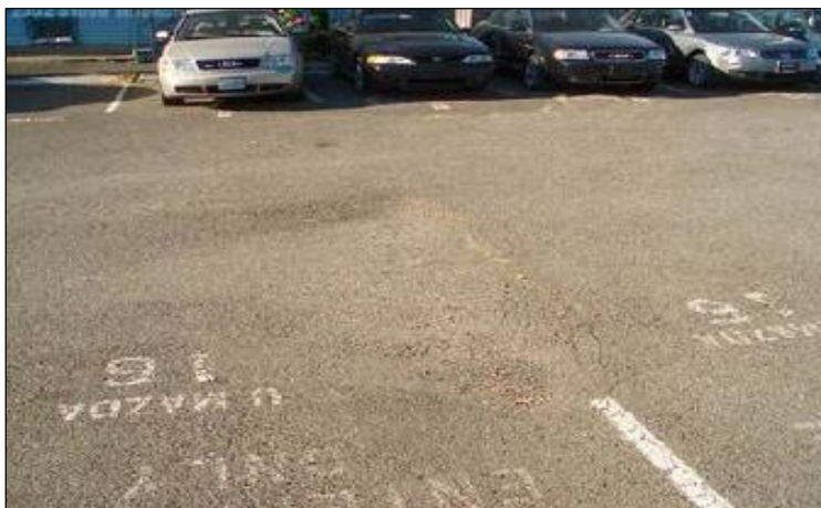
Figura 20: Falla tipo 4: Elevaciones y hundimientos nivel de severidad medio (M)
