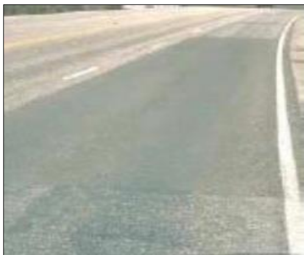
Figura 39: Falla tipo 11: Bacheo y zanjas reparadas de nivel de severidad bajo (L).
