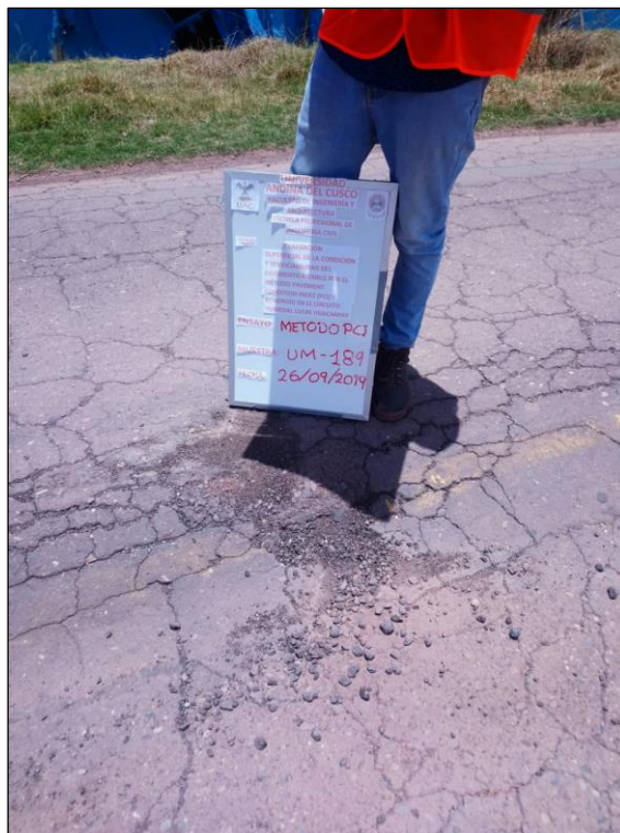
Figura 156: Identificación de la falla 19 (desprendimiento de agregados).
