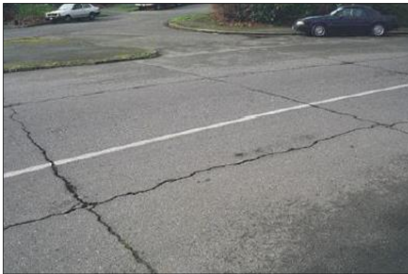
Figura 29: Falla tipo 8: Grietas de reflexión de juntas.
