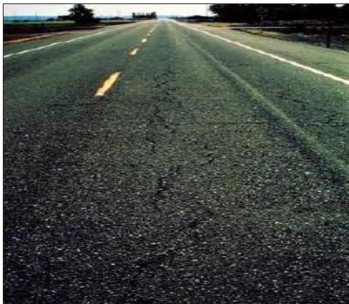
Figura 36: Falla tipo 10: Grietas longitudinales y transversales de nivel de severidad medio (M).
