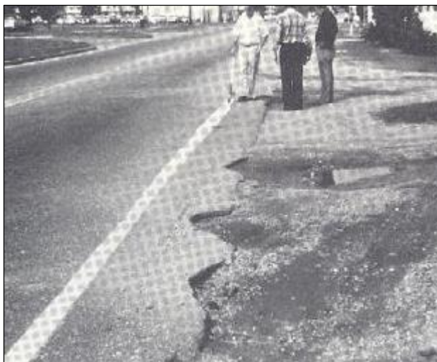
Figura 28: Falla tipo 7: Grietas o fisuras de borde de nivel de severidad alto (H).
