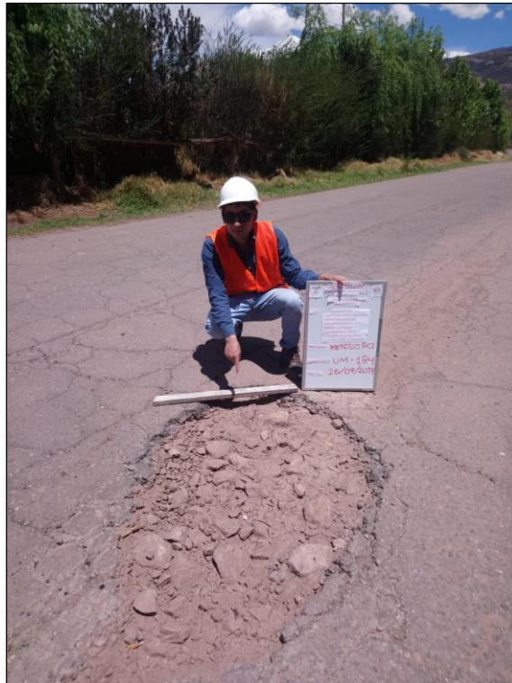
Figura 159 : Identificación de la falla 13 (huecos).
