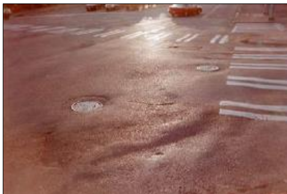
Figura 51: Falla tipo 15: Deformación por empuje de nivel de severidad alta (H).
