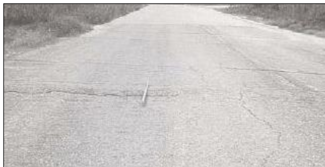
Figura 56: Hinchamiento de severidad media (M).
