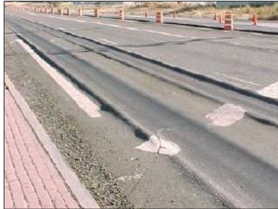
Figura 48: Falla tipo 14: Ahuellamiento de nivel de severidad alto (H).
