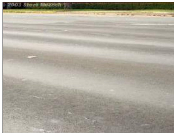
Figura 47: Falla tipo 14: Ahuellamiento de nivel de severidad medio (M).
