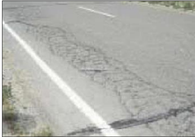
Figura 8: Falla tipo (1): Piel de cocodrilo
