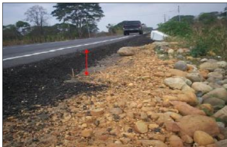
Figura 32: Falla tipo 9: Desnivel calzada-hombrillo.
