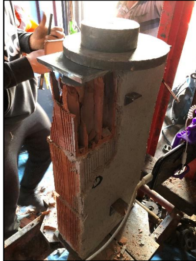
Figura 22 Falla por aplastamiento local – Prisma 2 y 2 C
