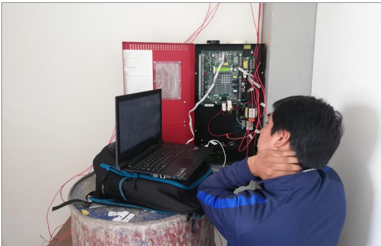
Figura 66. Codificación de tablero contraincendios.
