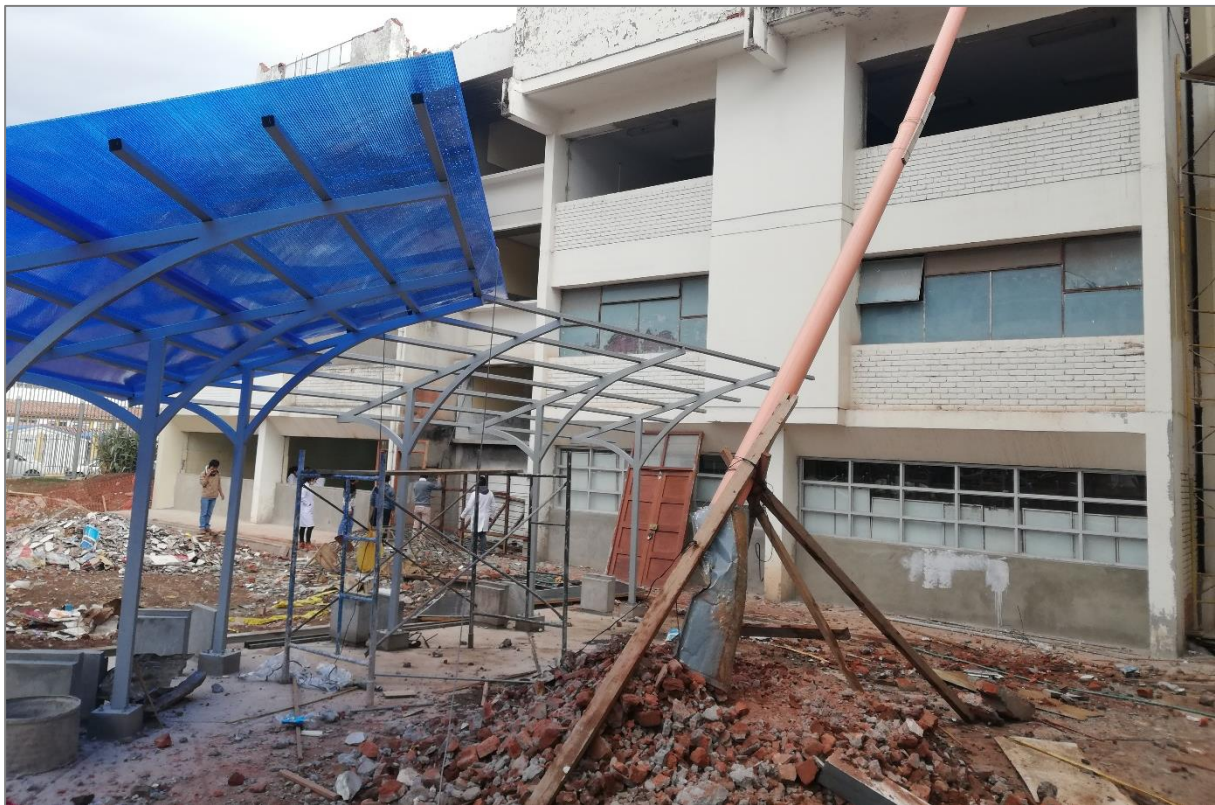
Figura 55. Instalación de plancha de policarbonato en pérgola y acopio de material excedente.
