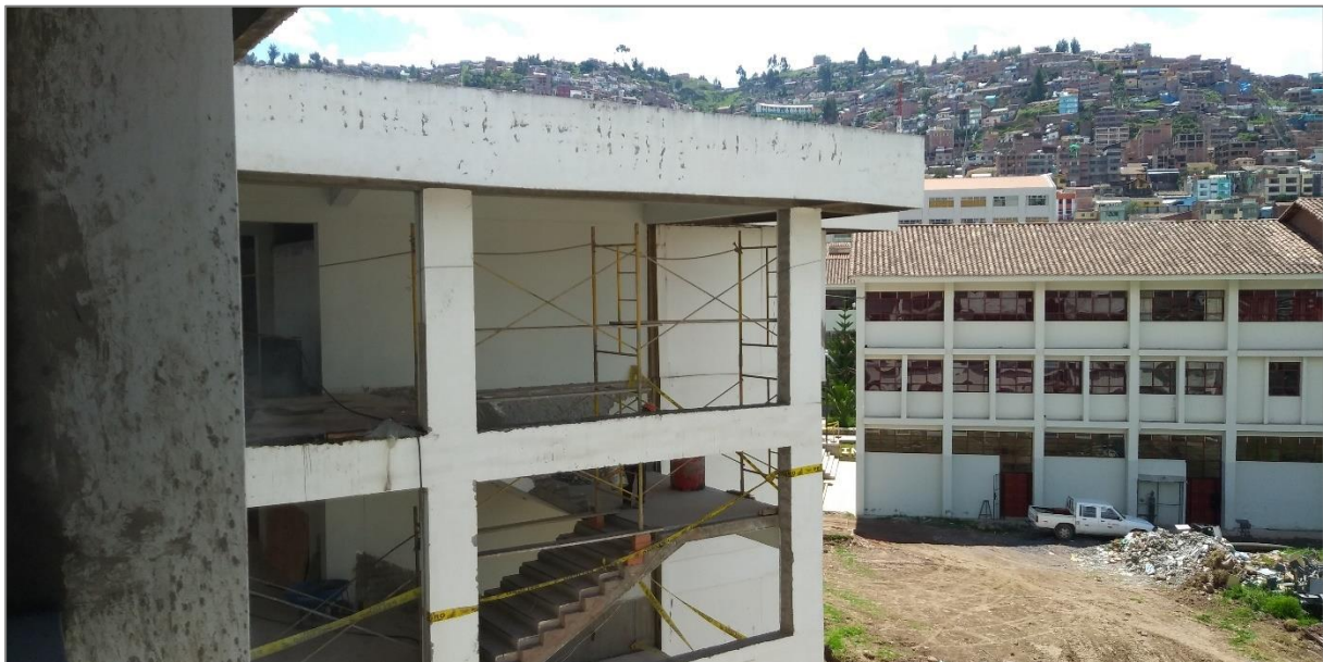
Figura 28. Exteriores del pabellón luego de la demolición de muros y desmontaje de mamparas.
