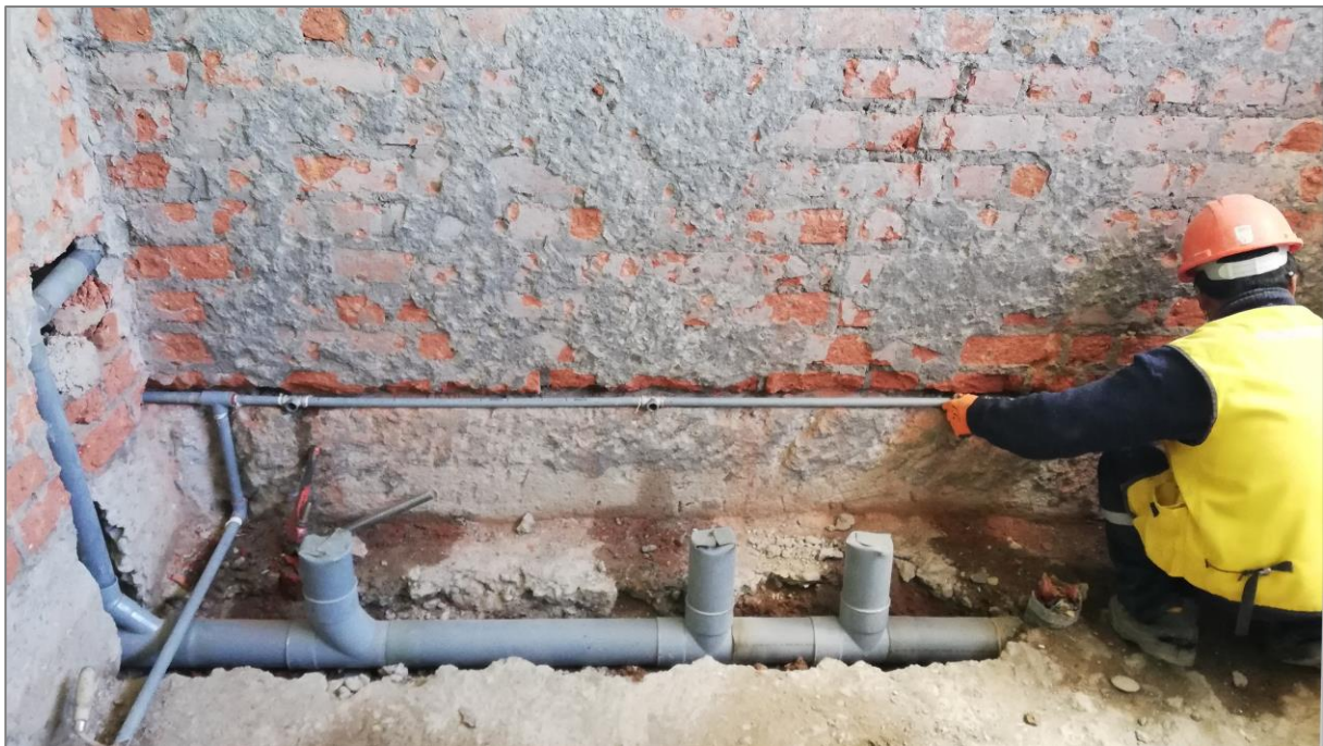
Figura 45. Instalaciones sanitarias en servicios higiénicos.
