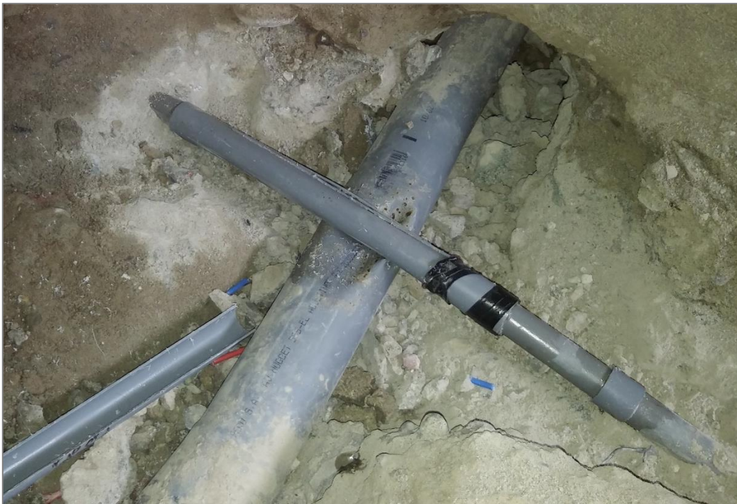
Figura 16. Interferencia entre las Instalaciones Sanitarias y las Instalaciones Eléctricas encontradas durante la demolición del contrapiso de los servicios higiénicos.
