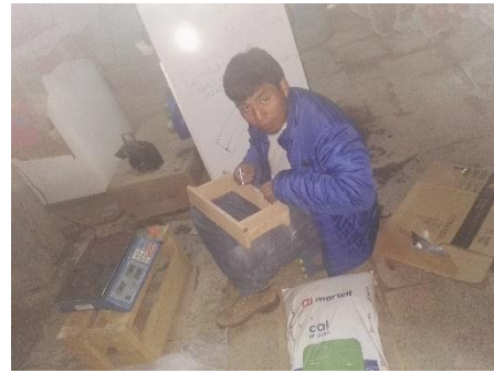
Figura 178 : Marcado de los moldes de adobe para la separacion de la cal con respecto al volumen del molde (se repite este proceso para cada porcentaje de adiccion).
