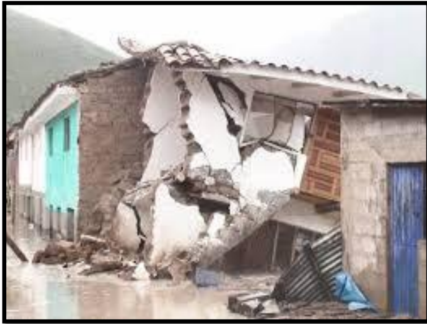
Figura 2 : Colapso de vivienda – provincia Calca.
