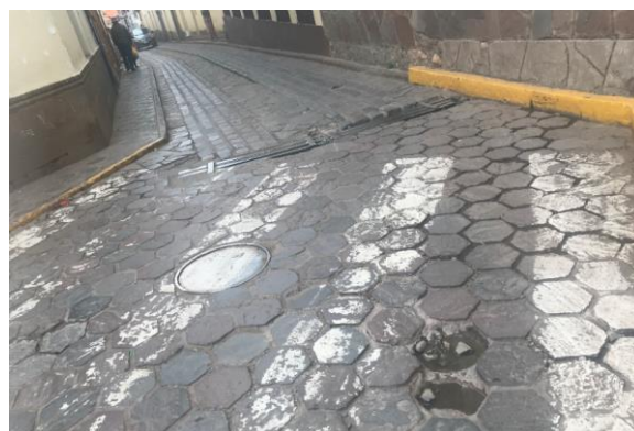
Figura 247. Paso peatonal en mal estado en la calle Carmen Bajo
