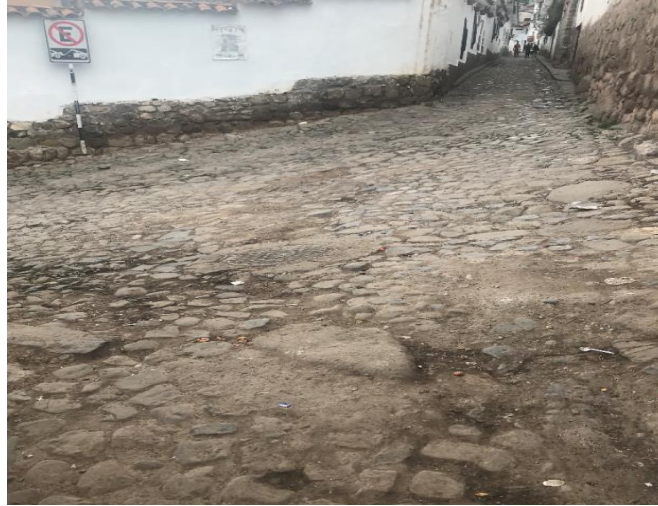
Figura 248. Paso peatonal en mal estado en la calle 7 Angelitos
