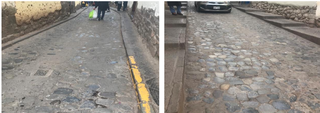
Figura 253. Carpeta de rodadura en mal estado en la Cuesta San Blas
