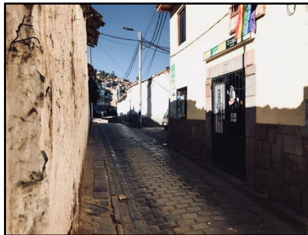
Figura 26. Levantamiento superficial en la carpeta de rodadura
