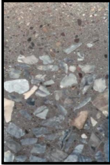
Figura 10 Segregación del Concreto
