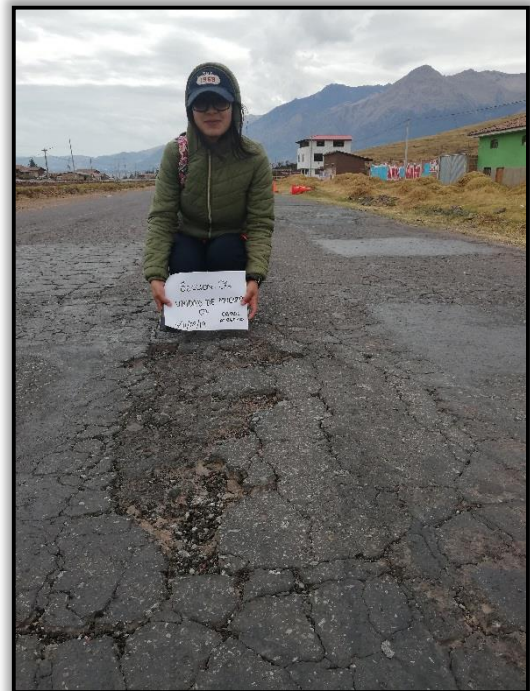
Figura 23: Falla peladura severidad media Fuente: Propia
