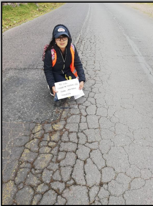
Figura 20: Falla piel de cocodrilo de severidad alta Fuente: Propia
