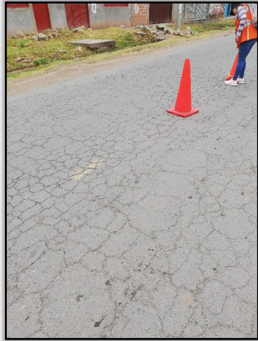
Figura 21: Falla piel de cocodrilo de severidad media Fuente: Propia
