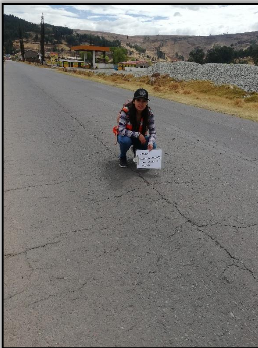
Figura 22: Falla fisura longitudinal de severidad media Fuente: Propia
