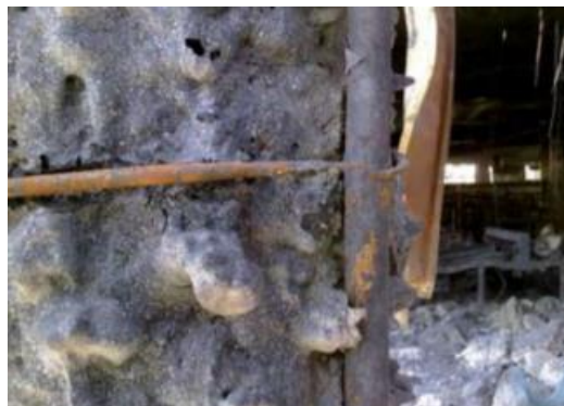
Figura 13 Estribo cortado por efectos de altas temperaturas
