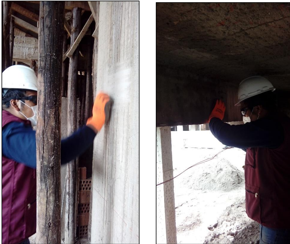
Figura Nro. 93: limpieza de elementos estructurales haciendo uso de la piedra abrasiva
