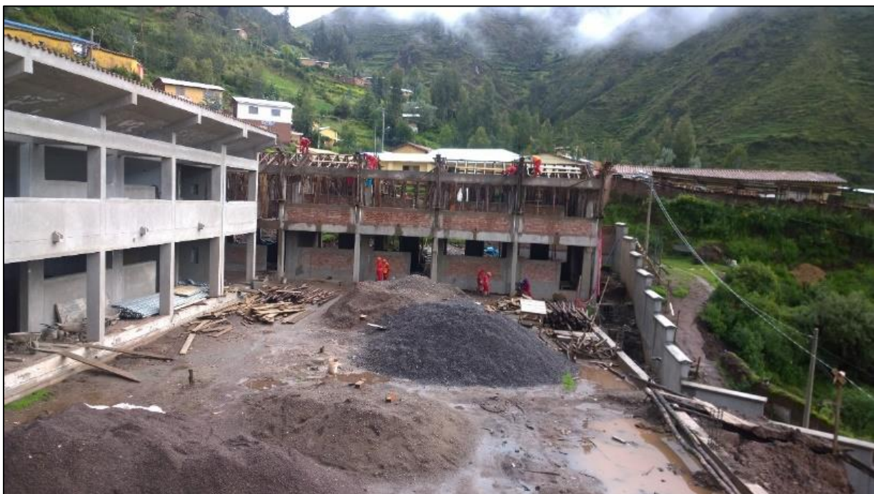
Figura Nro. 1: Vista frontal del bloque 01 de Institución Educativa N°50217 de la comunidad de Umachurco en etapa de construcción
