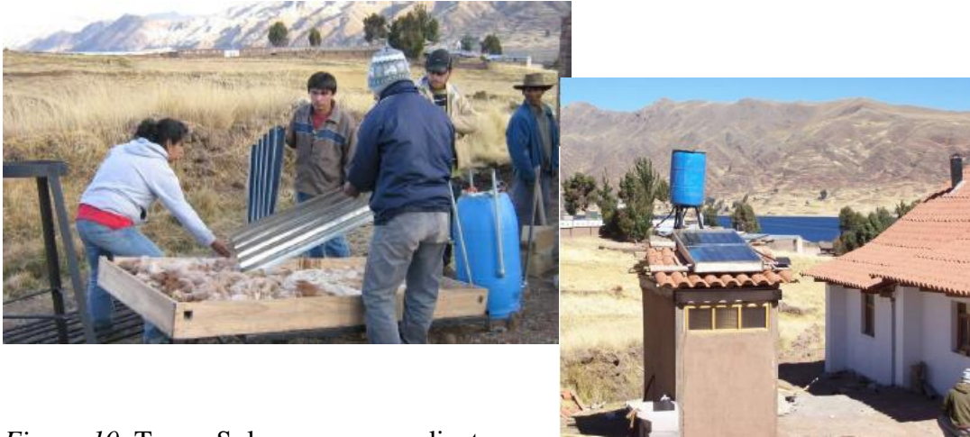
Figura 10. Terma Solar para agua caliente (Hadzich)
