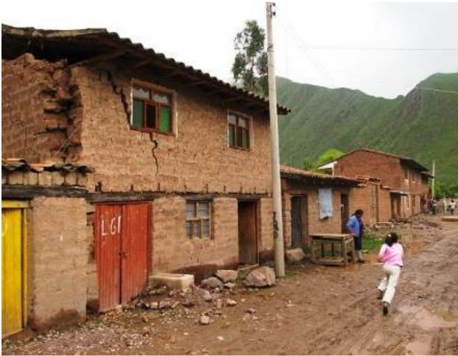
Figura 1. Colapso de Viviendas por Fuertes Lluvias Recuperado del Instituto Nacional de Defensa Civil
