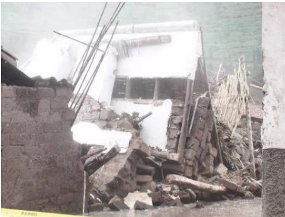
Figura 2. Colapso de Viviendas por Fuertes Lluvias Recuperado del Instituto Nacional de Defensa Civil
