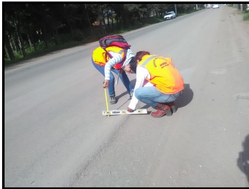
Figura 78: Medición de la Profundidad de falla Fuente: Elaboración Propia
