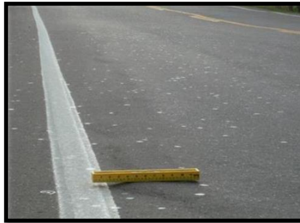
Figura:40 Abultamientos o desplazamientos (DM)
