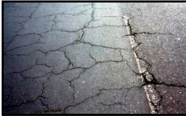
Figura 11 Agrietamiento en bloque
