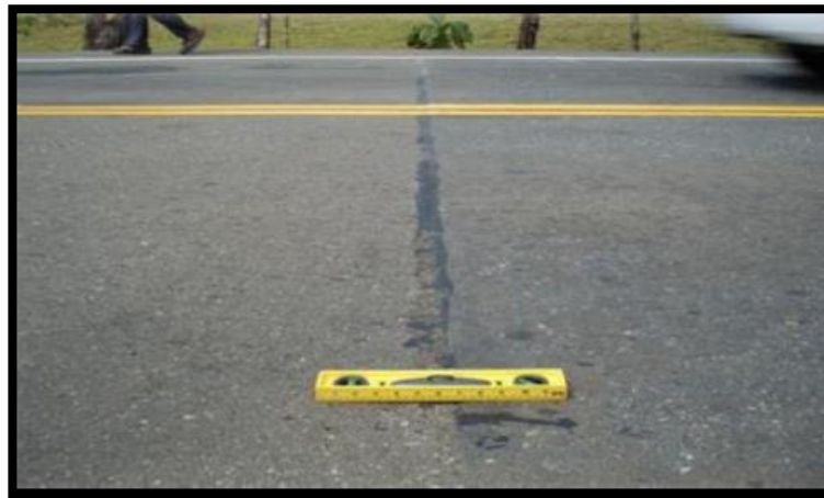
Figura 36 Fisura transversal de junta de construcción (FTJ)
