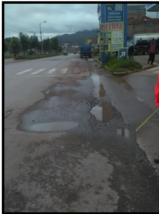
Figura 82: Medición de Falla Hundimiento
