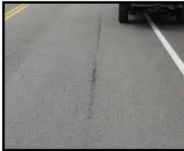
Figura 35 Fisura longitudinal de junta de construcción (FLJ)
