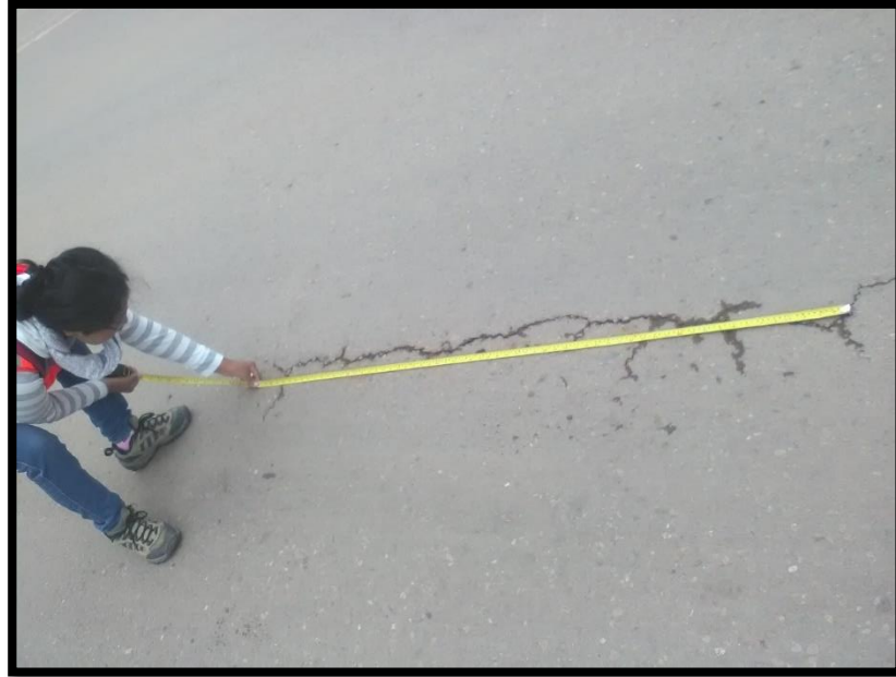
Figura 81: Medición de la Longitud de la Falla Fisura Longitudinal
