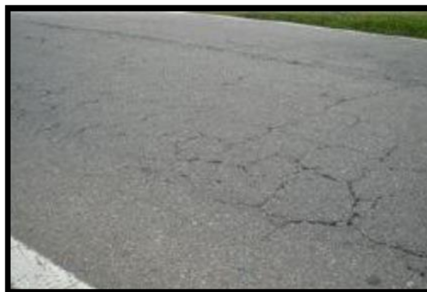
Figura 33 Fisura piel de cocodrilo (FPC)
