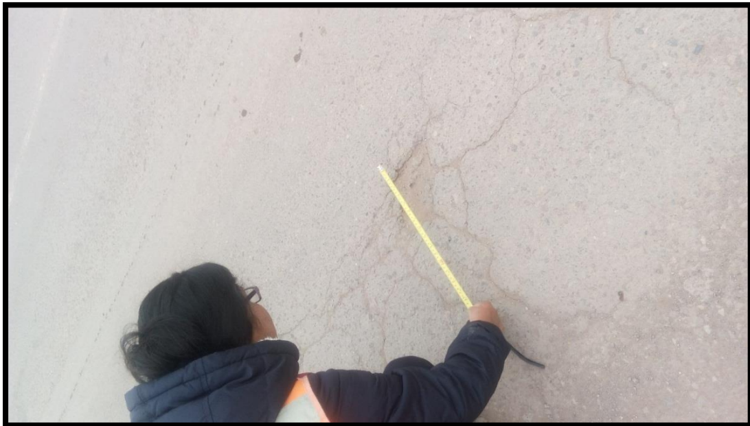
Figura 86: Medición de Falla tipo Fisuras en Bloque Fuente: Elaboración Propia
