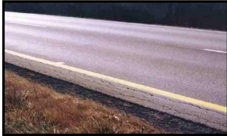
Figura 20 Grieta de borde.
