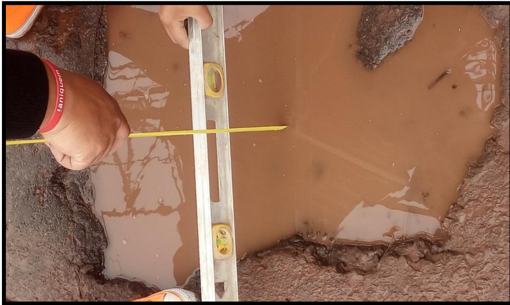
Figura 85: Medición de Profundidad de Falla tipo Huevo Fuente: Elaboración Propia
