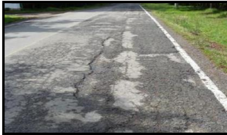
Figura 43 Pérdida de agregado (PA)
