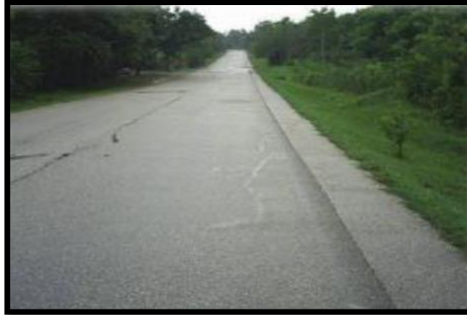
Figura 50 Escalonamiento entre calzada y berma (ECB)
