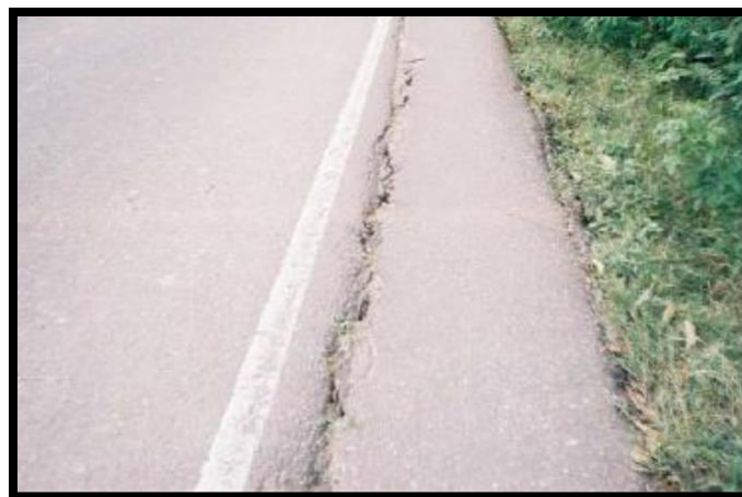
Figura 22 Desnivel carril/ berma.
