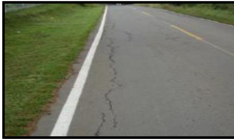
Figura: 39 Fisura de Borde (FB)
