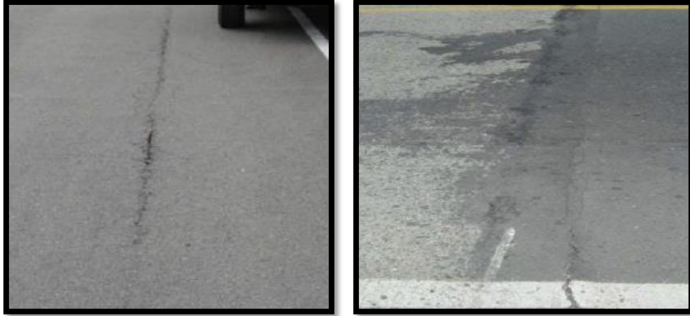
Figura 23 Grietas longitudinales y transversales.
