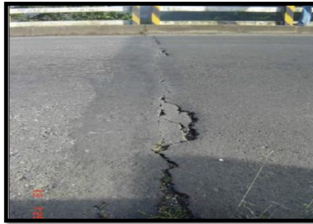
Figura 21 Grieta de reflexión de junta.
