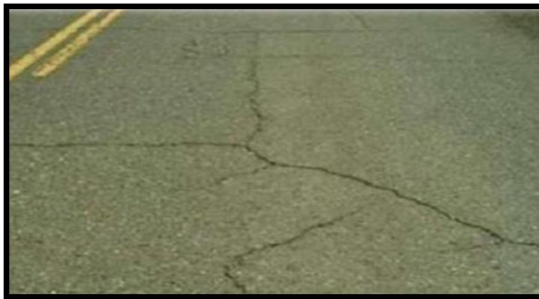
Figura 37 Fisura de contracción térmica (FCT)
