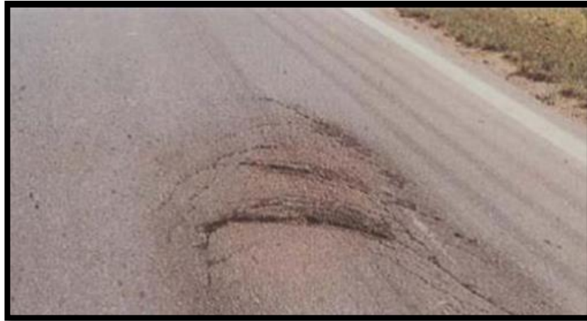
Figura 38 Fisura Parabólica (FP)
