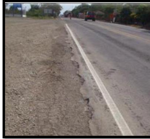
Figura 51 Erosión de las bermas (EB)
