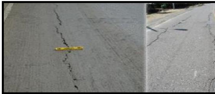
Figura 32 Fisura longitudinal por fatiga (FLF)
