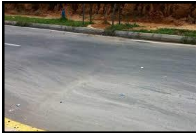
Figura: 31 Depresiones o hundimientos transversales (DT)
