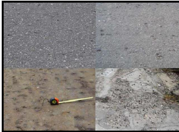
Figura 28 Desprendimiento de agregados.
