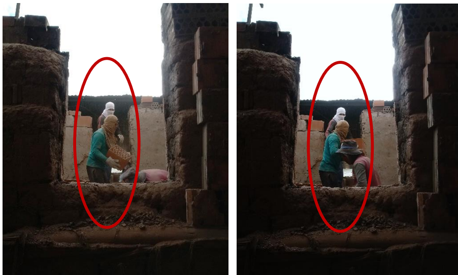
Figura 62: Riesgo Químico - Particulado, Humos provocado por el combustible utilizado en el horno. Fotografía Propia
