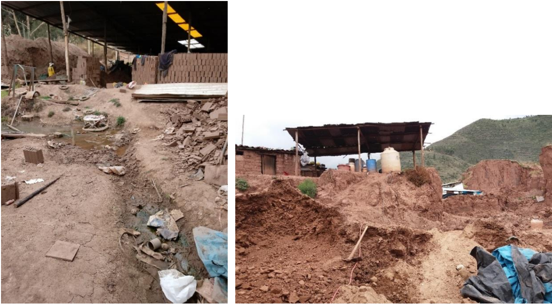
Figura 74: Peligro Locativo - Suelo Irregular. Fotografía Propia
