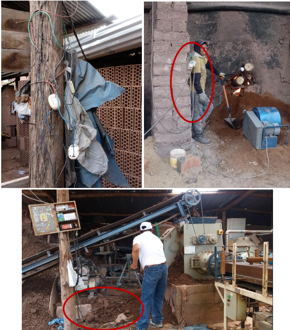
Figura 73: Instalaciones eléctricas deficientes. Fotografía Propia.
