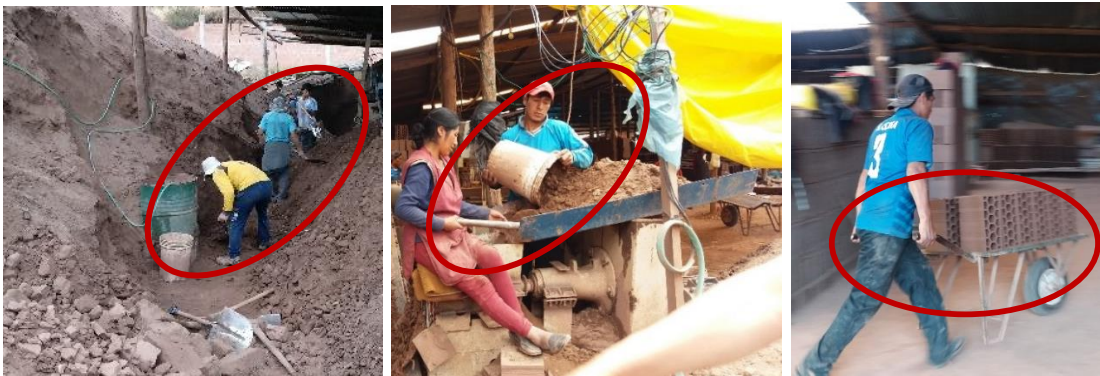
Figura 66: Peligro Ergonómico - Posturas inadecuadas al momento de hacer usos de herramientas manuales. Fotografía Propia.
