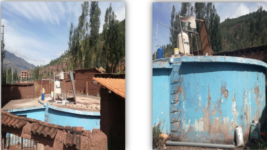
Figura 10 Reservorios de 220 m 3
