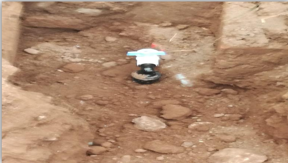
Figura 13 Instalación domiciliaria de la llave de paso
