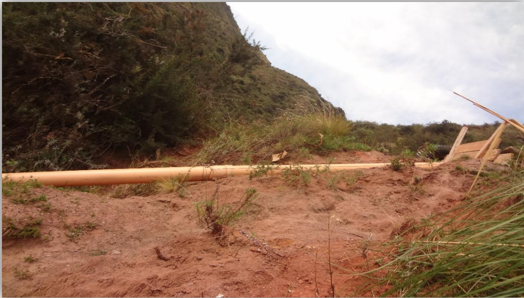
Figura 12 Conexiones de tuberías para su respectiva distribución
