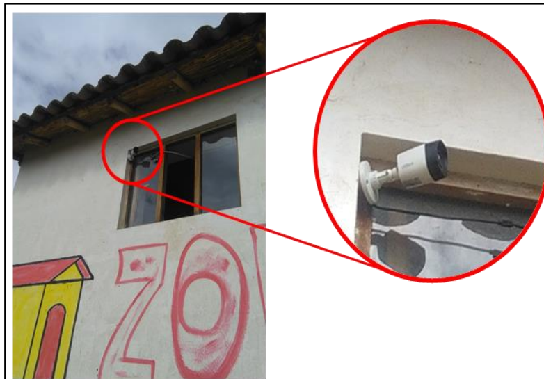
Figura 16. Instalación de cámara de video vigilancia en la comunidad de Ccopi. Fuente: Elaboración propia, 2018.
