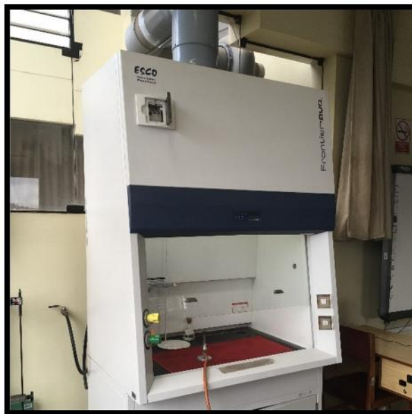
Figura 29: Campana de extracción de gases
