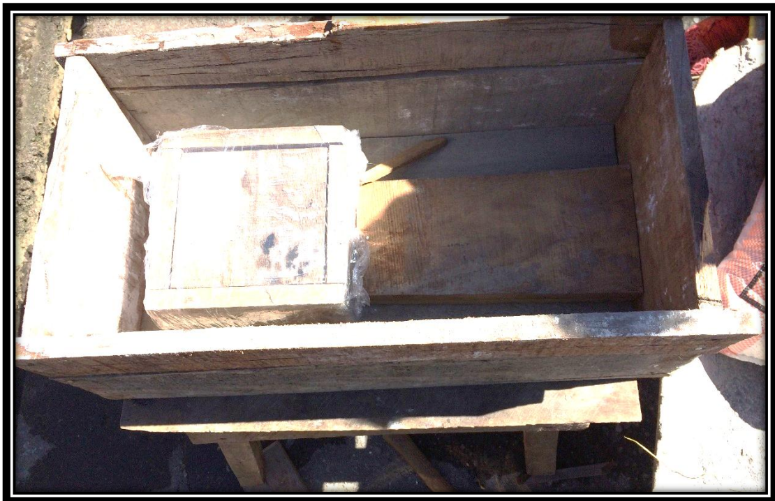
FIGURA N° 90 ENCOFRADO PARA EL MODELO DE YESO CON EL DOBLE DE LA LONGITUD CARACTERÍSTICA
