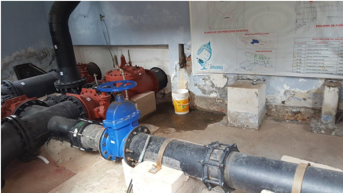
Figura N° 16 Tubería De Ingreso Al Reservorio Los Andenes (R-1)
