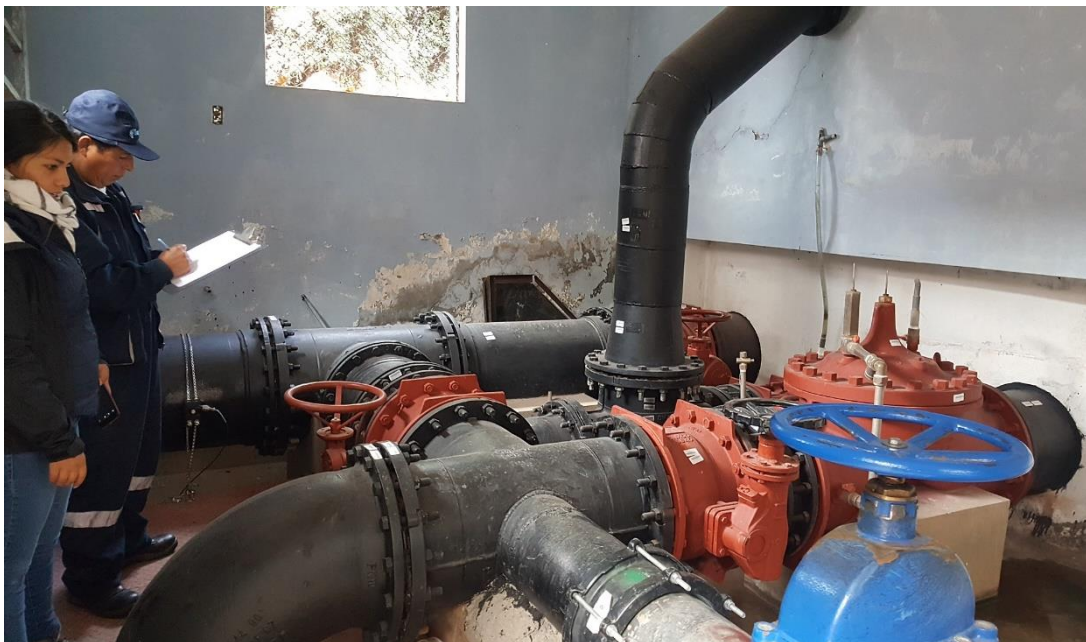
Figura N° 15 Tuberías De Salida, Limpia Y By-Pass Del Reservorio Los Andenes (R-1)
