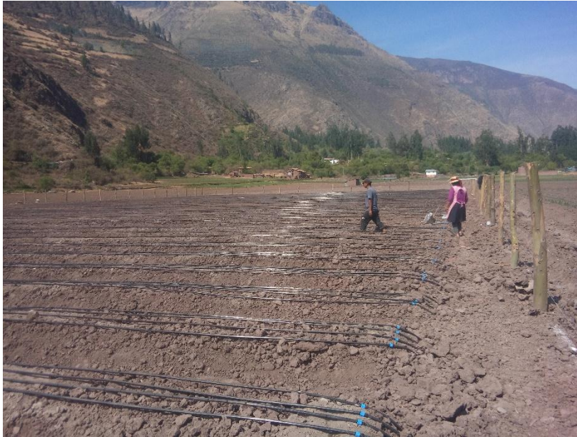
Riego tecnificado para la fresa
