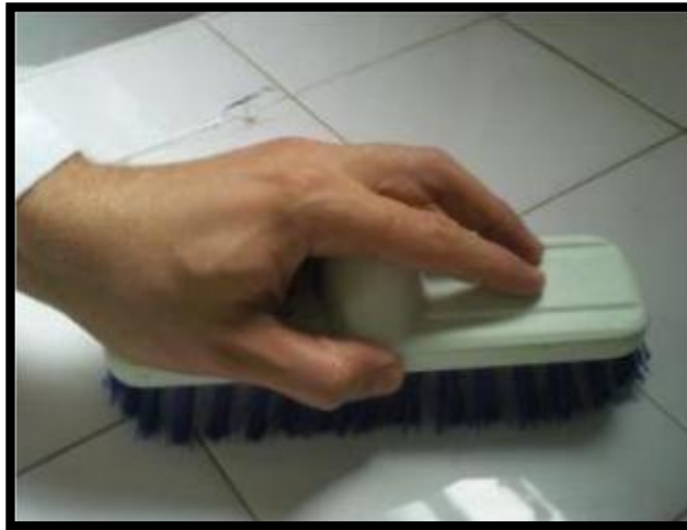
Figura 24. Limpieza en seco de todos los residuos que existen sobre la superficie.
