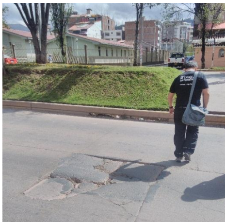
Figura 1 - Falla por inadecuado soporte de base en el pavimento de la Av. 28 de Julio
