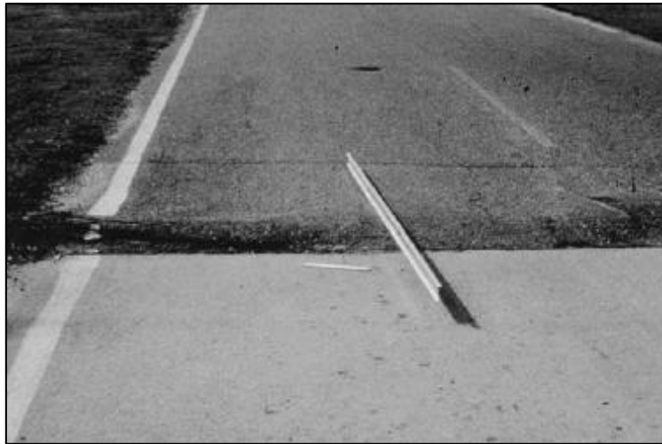
Figura 26. Desplazamiento de severidad alta.
