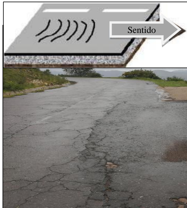
Figura 27. Grieta Parabólica de severidad alta.
