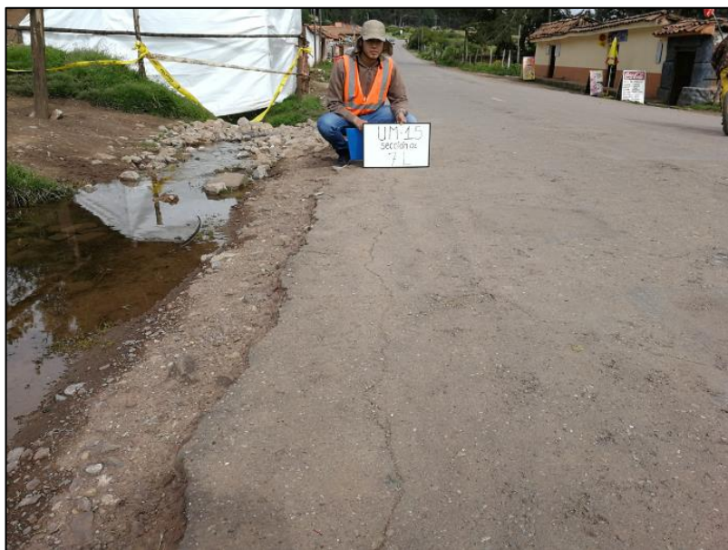
Figura 16. Falla Grieta de Borde de severidad baja.
