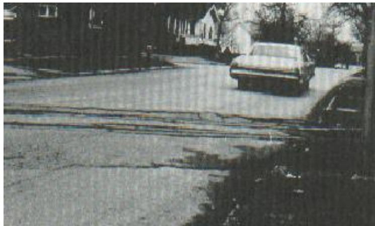
Figura 24. Cruce de Vía Férrea de severidad media.
