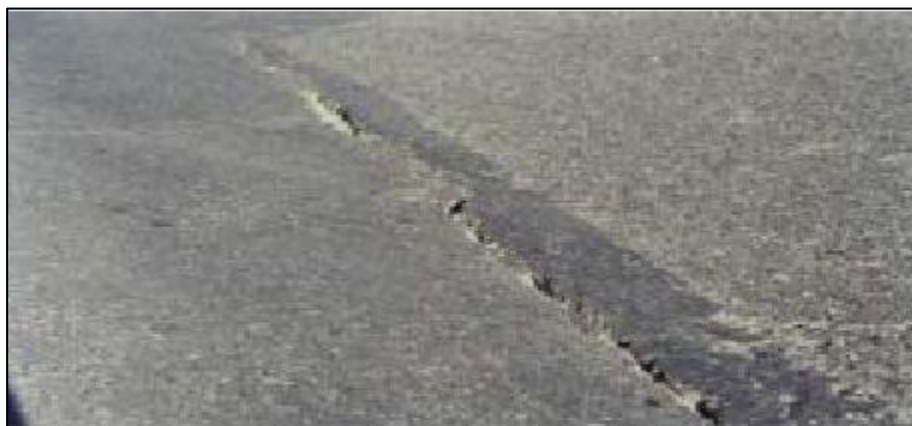
Figura 17. Falla Grieta de Reflexión de Junta de severidad media.
