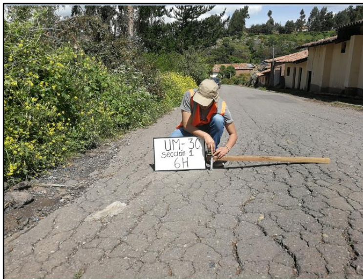
Figura 15. Falla Depresión de severidad alta.
