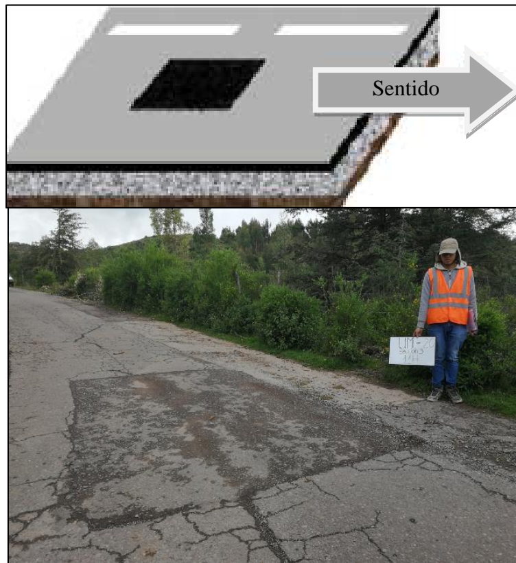
Figura 20. Parcheo de severidad alta.
