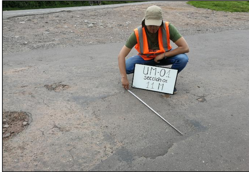
Figura 35. Medición de las Fallas en el pavimento flexible.
