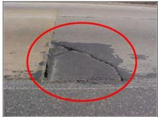
FIGURA N°18: Grietas de Esquina FUENTE: (CLASIFICACIÓN DE LAS FALLAS DE PAVIMENTO FLEXIBLES Y RIGIDOS, 2010)
