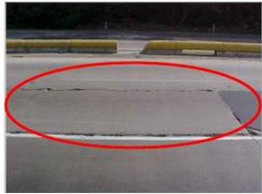
FIGURA N°21: Grietas de Restricción FUENTE: Oficina técnica, Ing, José Heredia
