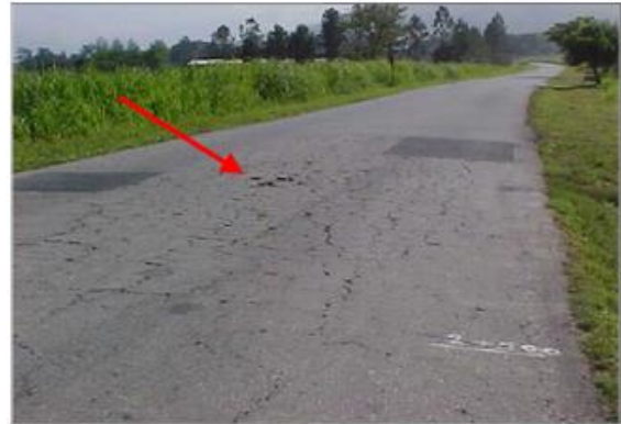
FIGURA N°14: Agrietamientos Superficiales FUENTE: (CLASIFICACIÓN DE LAS FALLAS DE PAVIMENTO FLEXIBLES Y RIGIDOS, 2010)
