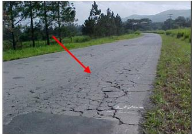
FIGURA N° 16: Piel de Cocodrilo FUENTE: (CLASIFICACIÓN DE LAS FALLAS DE PAVIMENTOFLEXIBLES Y RIGIDOS, 2010)
