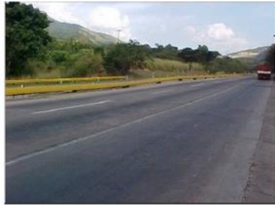
FIGURA N°23: Deformaciones FUENTE: (CLASIFICACIÓN DE LAS FALLAS DE PAVIMENTO FLEXIBLES Y RIGIDOS, 2010)
