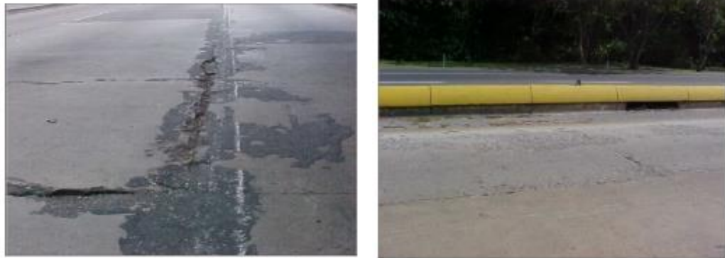
FIGURA N° 25 y 26: Descascaramientos y escamaduras FUENTE: (CLASIFICACIÓN DE LAS FALLAS DE PAVIMENTO FLEXIBLES Y RIGIDOS, 2010)
