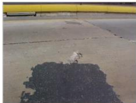
FIGURA N°24: Baches FUENTE: (CLASIFICACIÓN DE LAS FALLAS DE PAVIMENTO FLEXIBLES Y RIGIDOS, 2010)
