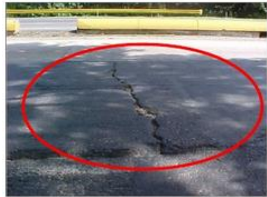
FIGURA N°22: Grietas Transversales FUENTE: (CLASIFICACIÓN DE LAS FALLAS DE PAVIMENTO FLEXIBLES Y RIGIDOS, 2010)
