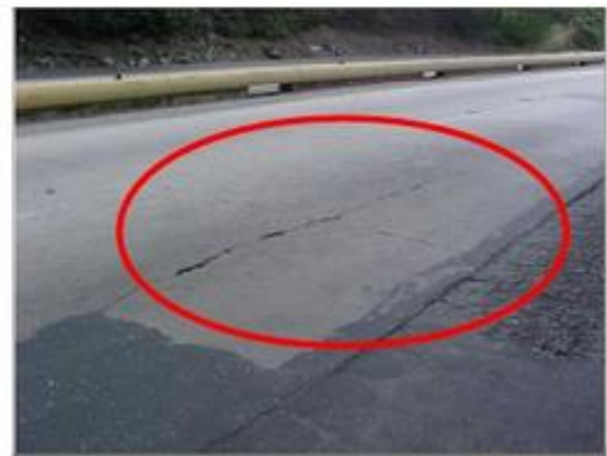
FIGURA N°20: Grietas Longitudinales FUENTE: (CLASIFICACIÓN DE LAS FALLAS DE PAVIMENTO FLEXIBLES Y RIGIDOS, 2010)
