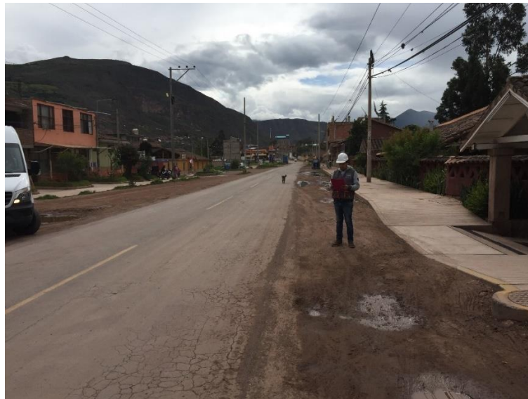
FIGURA N°31: Inicio de Avenida Ferrocarril Tramo 01
