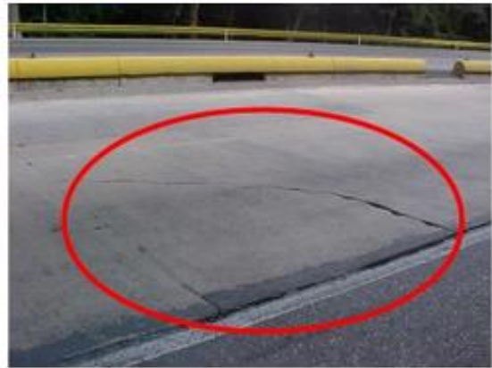
FIGURA N°19: Grietas Diagonales FUENTE: (CLASIFICACIÓN DE LAS FALLAS DE PAVIMENTO FLEXIBLES Y RIGIDOS, 2010)
