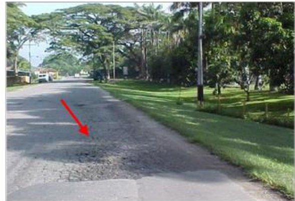
FIGURA N°15: Agrietamientos Profundos FUENTE: (CLASIFICACIÓN DE LAS FALLAS DE PAVIMENTO FLEXIBLES Y RIGIDOS, 2010)
