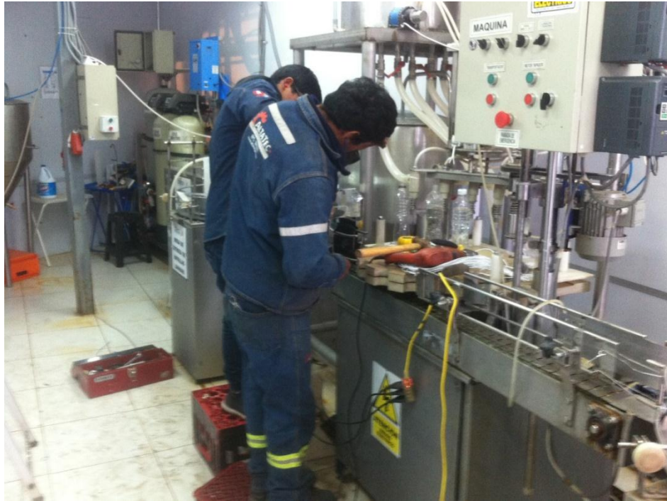
Figura 30. Conexión eléctrica a caja de fusibles.
