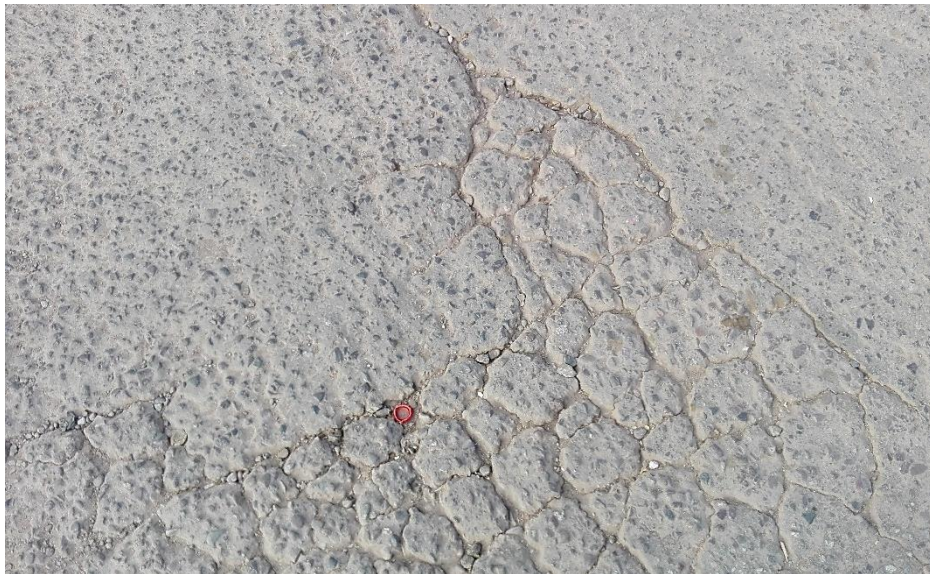
Figura 33: Falla piel de Cocodrilo - Av. Jorge Chávez
