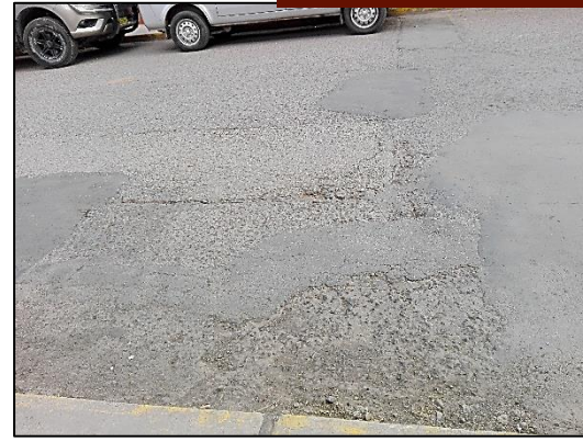
GRIETAS LONGITUDINALES Y PULIMIENTO
