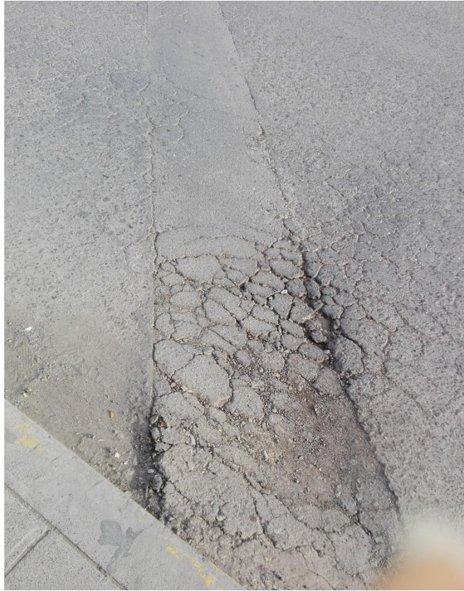
Figura 37: Parcheo por cortes de Instalaciones - Av. Jorge Chávez
