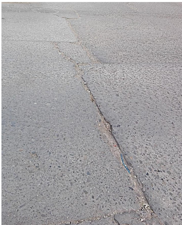
Figura 34: Grieta de Reflexión de Junta - Av. Jorge Chávez
