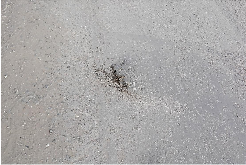
Figura 35: Deslizamientos - Av. Jorge Chávez
