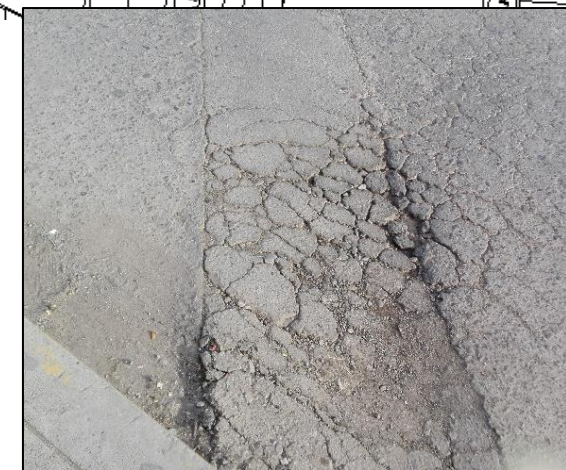
HUNDIMIENTO EN PARCHE
