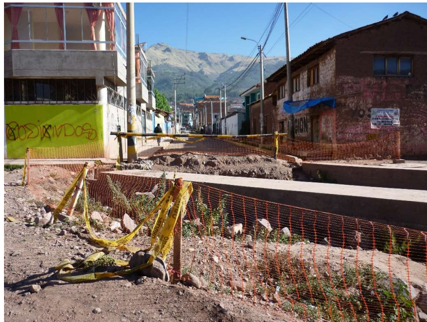
Figura N° 63 Bloqueo por modificaciones en la calzada del Eje N° 13 a la altura del Rio Huatanay vista en dirección norte
